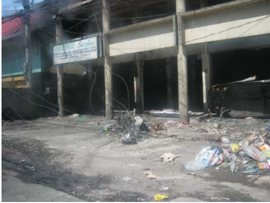
写真-5.26 背後の集落の被災（コンクリート造り） （タクロバン港）
