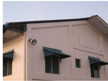
写真-5.7 港湾運営事務所の屋根の一部が破損 (ドマギット港)
