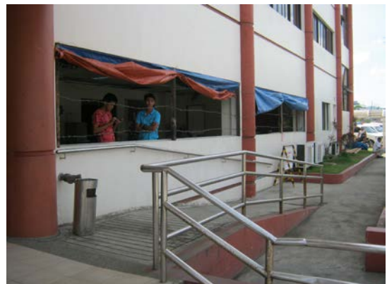
写真-5.25 1階の窓が破損した港湾運営事務所（タクロバン港）
