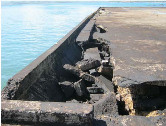
写真-4.7 エスタンシア港（港湾公社）の吸い出された護岸
