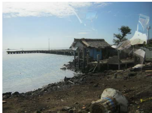
写真-5.4 破壊された沿岸警備隊の棧橋（手前） （エスタンシア港）
