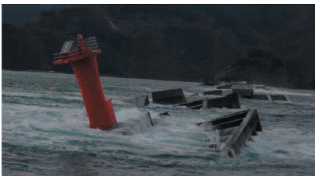
写真-2.3 現地被災状況(北堤堤頭部)
