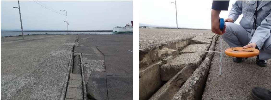
写真-5.6 石垣地区第二埠頭岸壁 (-5.5m) 中央部の U 字溝に見られた変形・段差 (2016年4月18日撮影)
