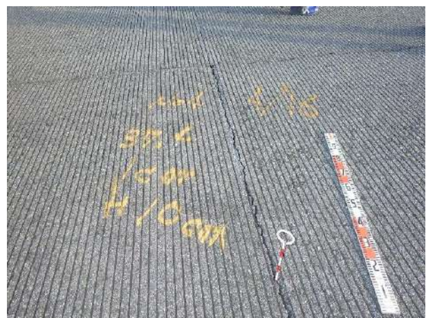
(d) ひび割れ 4
