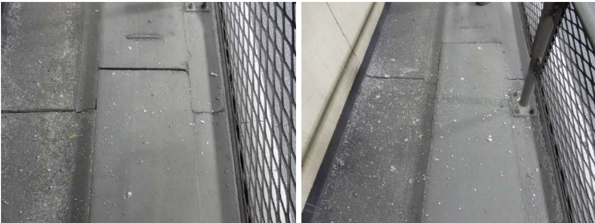
写真-7.5 本震後の調査で確認されたコンクリート小片
