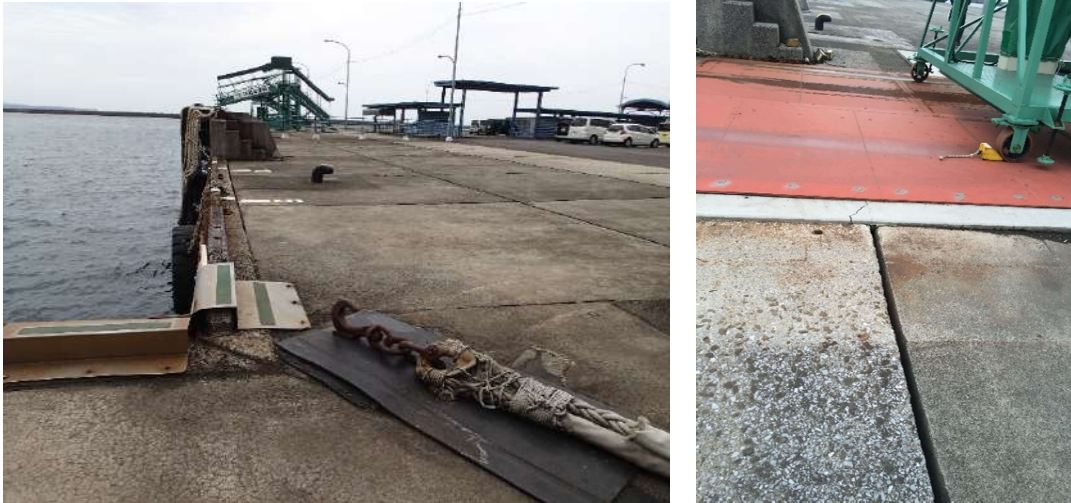
写真-5.5 石垣地区第二埠頭岸壁 (-5.5m) 北側の目地の開き (2016年4月18日撮影)
