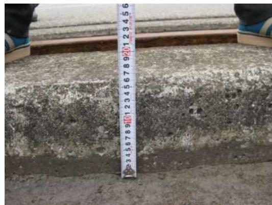
写真-6.2 鋼管矢板上部工～クレーン基礎間のアスファルト舗装の沈下
