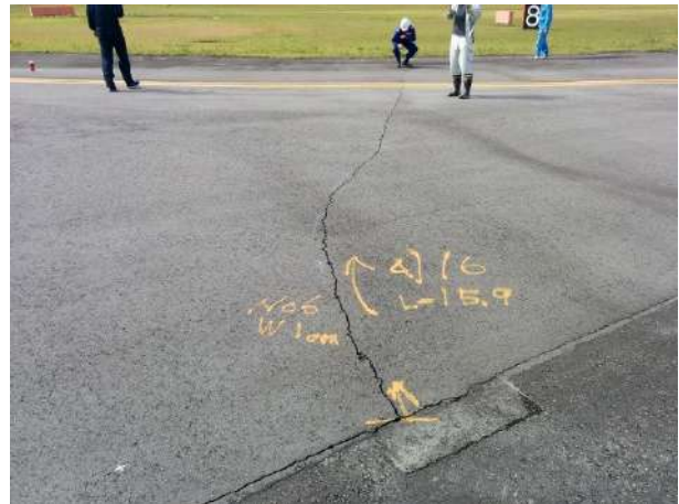
(b) ひび割れ 6
