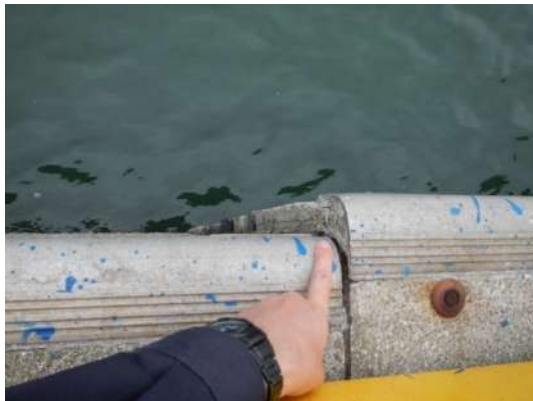
写真-6.5 上部工のずれ
