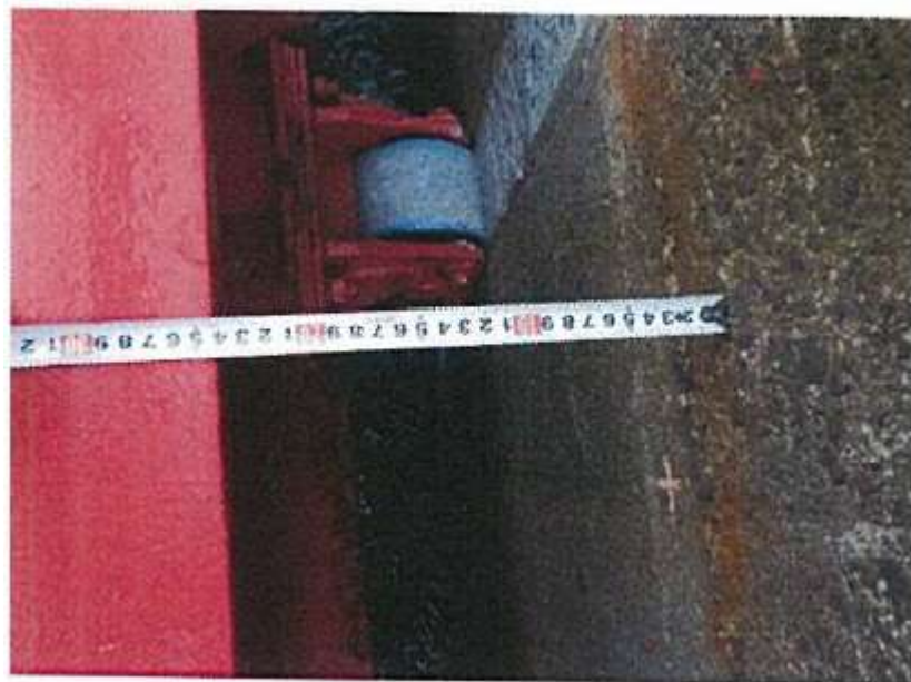
写真-5.11 可動橋右側のサイドローラーが壁に強く当たっている状況
