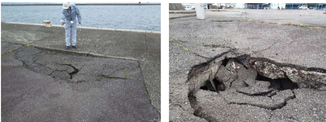
写真-5.8 石垣地区第二埠頭岸壁 (-5.5m) 南東側の隅角部での吸出しによる陥没 (2016年4月18日撮影)
