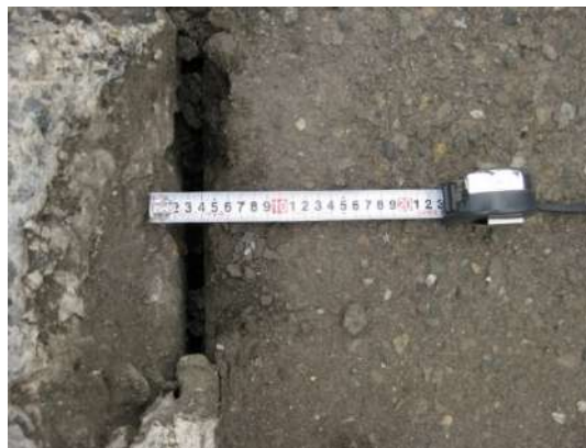
写真-6.1 鋼管矢板の上部工背後の開き
