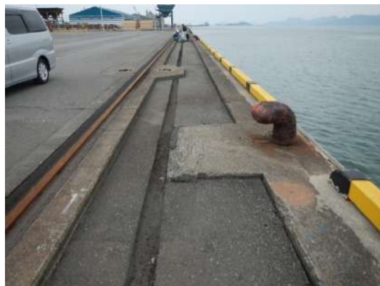
写真-6.7 岸壁上部工～クレーン基礎間の アスファルト舗装の沈下
