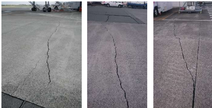
(a) ひび割れ西
