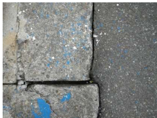
写真-6.6 上部工ずれ位置の背後にある補修跡
