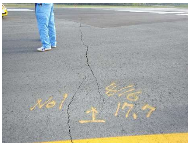
(a) ひび割れ 1
