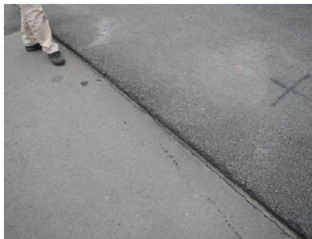
写真-6.9 エプロン部アスファルト舗装のクラック
