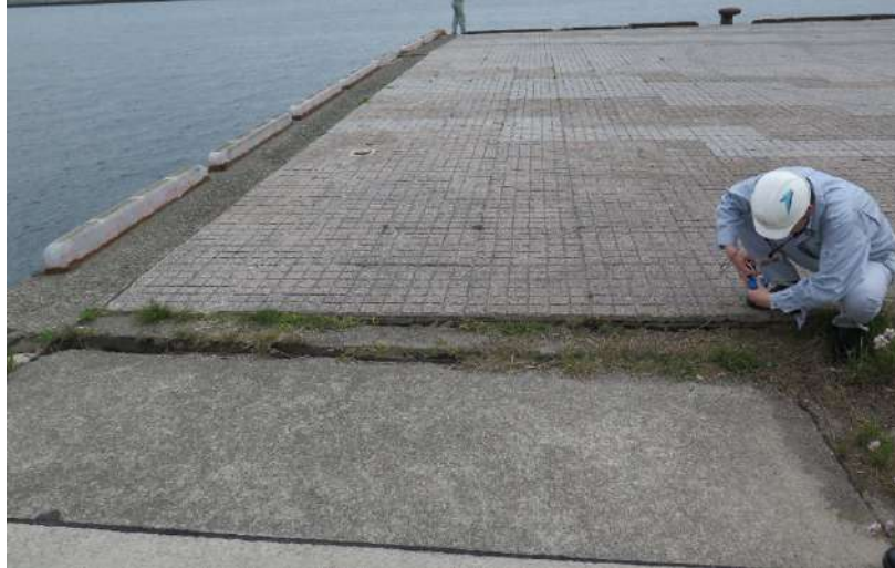
写真-5.2 石垣地区第三埠頭岸壁（-12m）ケーソン背後地盤の傾斜（2016年4月18日撮影）
