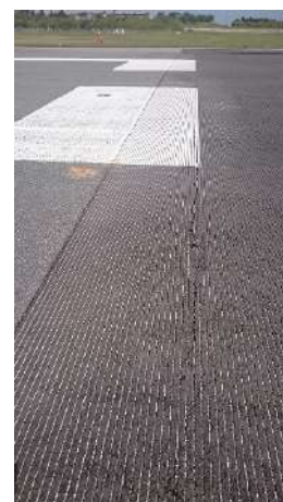
(b) ひび割れ 2
