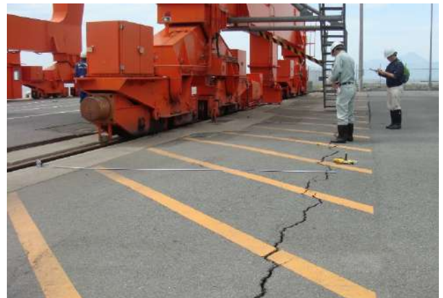
写真-4.2 岸壁（-7.5m）（図-4.1の①）背後の陸側クレーンレール基礎の陸側に生じたクラック（2016年4月16日撮影）
