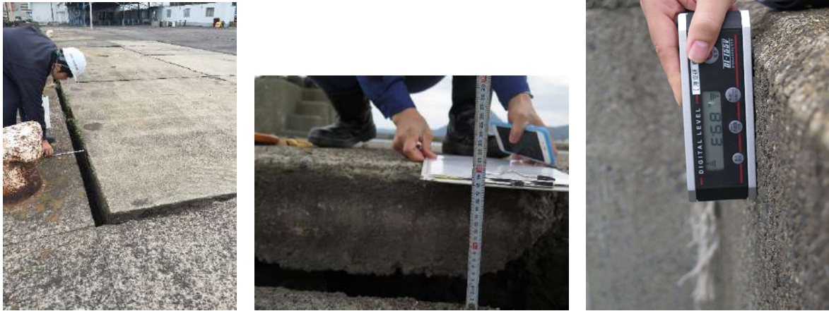
写真-5.7 石垣地区第二埠頭岸壁 (-5.5m) 南側の目地の開きと傾斜計による測定状況 (2016年4月18日撮影)
