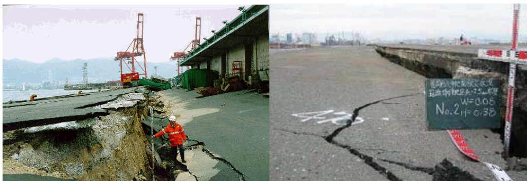
岸壁の背後に生じる段差
