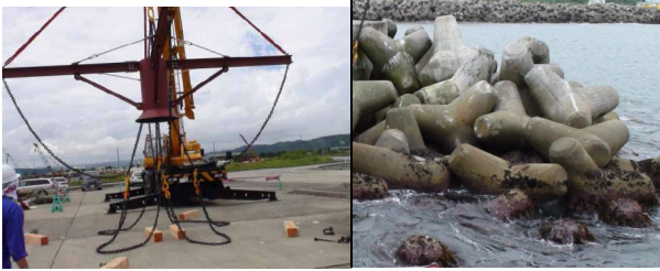
写真-17 16t用網チェーン式把持装置(左)とブロック撤去場所の状況
