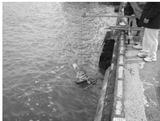
図-A.2 波高計の設置
