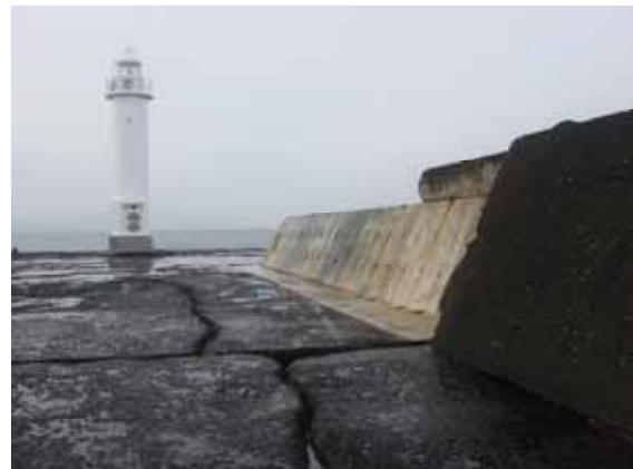
写真-2 留萌港西防波堤被災状況，被災部背面 (2008年11月28日撮影)
