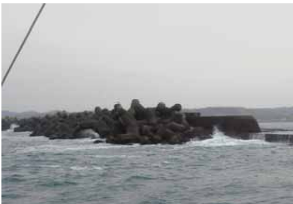
写真-1 留萌港西防波堤被災状況，被災部正面 (2008年11月28日撮影)
