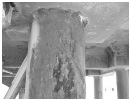
写真-1 塗装工法により防食した鋼管杭の劣化事例 (暴露20年, エポキシ樹脂塗装系)
