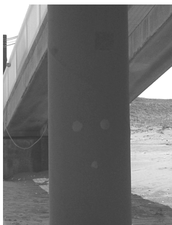
写真-8 波崎海洋観測施設での長期暴露試験結果 (塗装系: N6, 暴露 24 年経過)
