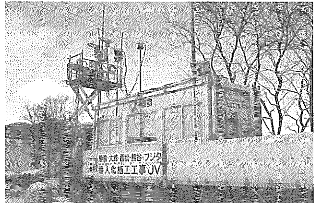
図-A.3 遠隔作業室及び高所カメラ
