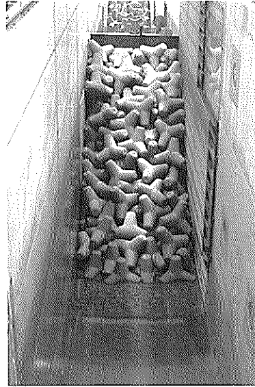
写真-4.7 ブロック沈下状況
