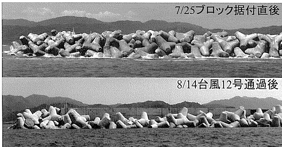
写真-1.1 消波ブロック被覆堤の消波ブロックの沈下例 (室津港)
