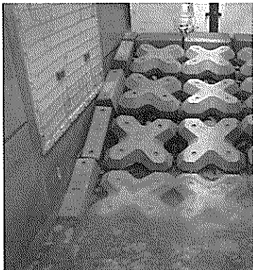
写真-4.8 被覆ブロックの変形状況
