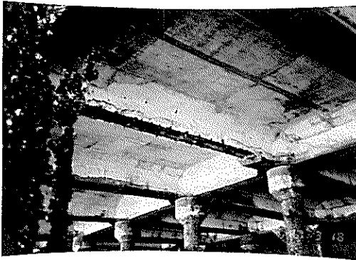
写真-1 劣化した上部工
