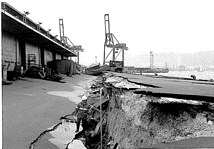
写真-1 ケーソン式岸壁の被災状況
