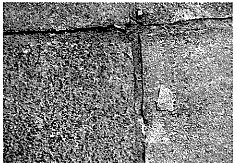
写真 16 自然石の目地の破損
