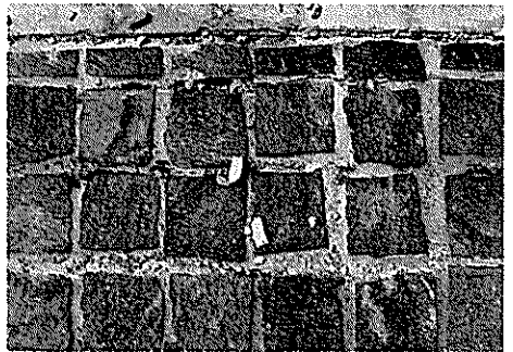
写真 15 擬石平板の目地の破損
