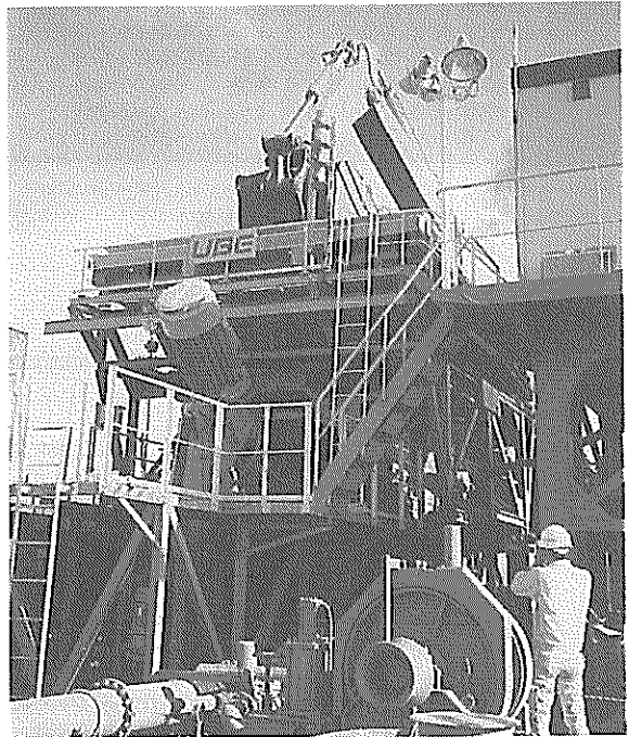
写真-2 熊本プラント(2)
