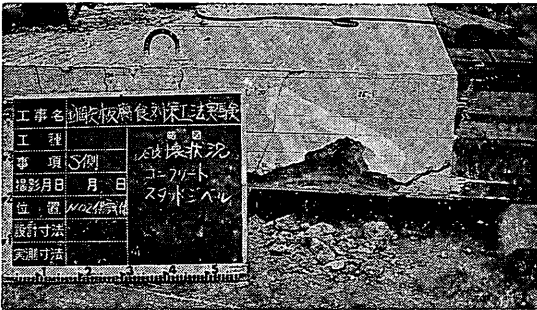
図-40 ひびわれ状況 (No. 1)
