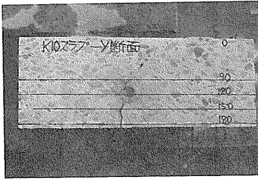
写真-4.4 幅員方向に発生した下面クラック
