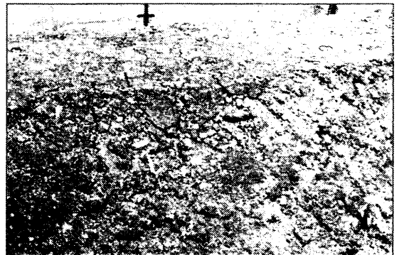
写真-3 天端に生じた微小亀裂
