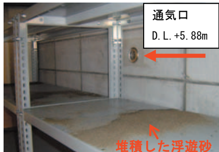
写真-17 倉庫内の浸水状況
