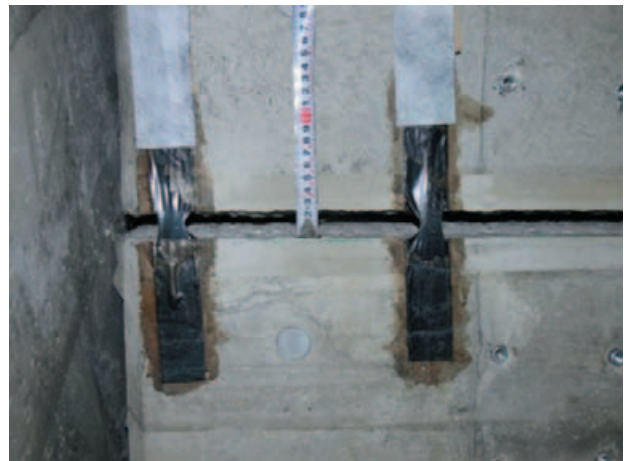
写真-3.11 ケース D10-5 実験後の打継ぎ部のひび割れ
