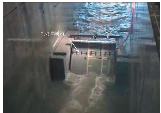
写真-3.5 4波目にて打継ぎ部にひび割れが発生
