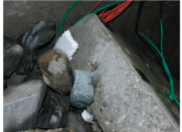
写真-3.9 打継ぎ部の差筋の破断状況(本体部)
