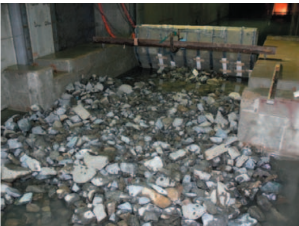
写真-3.22 波高 1.1m 作用後の裏込部の様子
