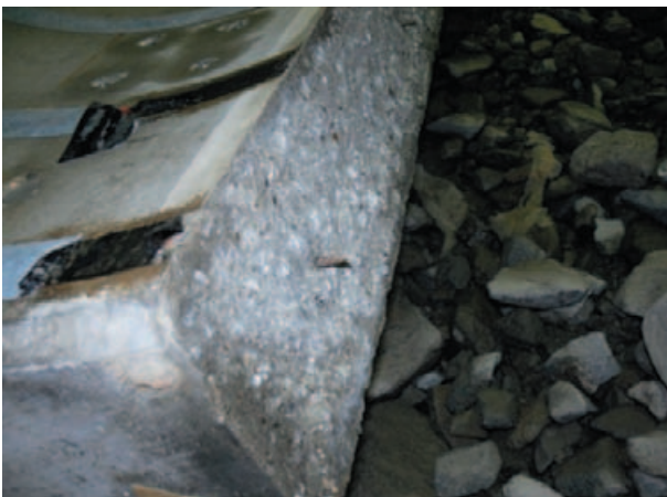
写真-3.8 打継ぎ部の差筋の破断状況(波返し部)
