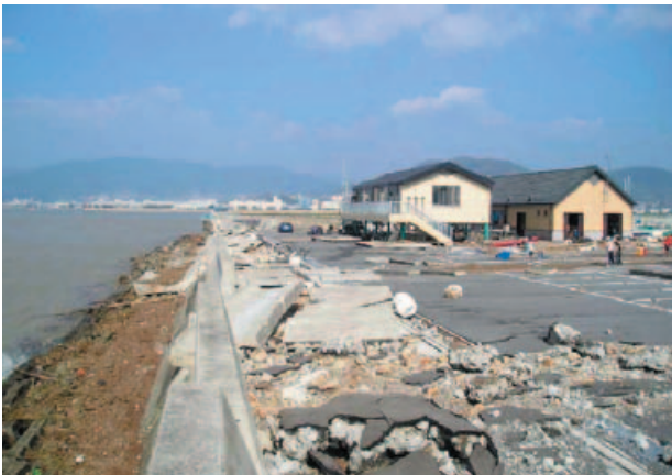
写真-1.1 もたれ式護岸の被災と背後洗掘の状況
