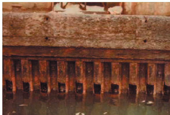
写真-3.1 鋼矢板の腐食事例
