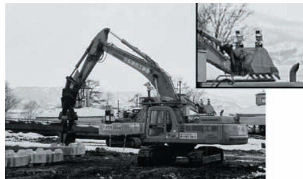
図-2.4 バケット背面にカメラを搭載した移動カメラ車
