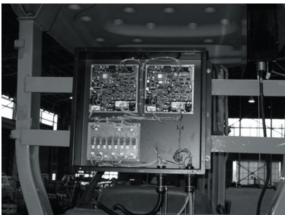
図-4.25 バルブドライバ設置状況
