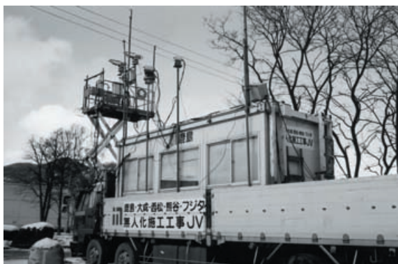
図-2.2 遠隔作業室及び高所カメラ
