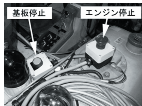
図-4.27 非常停止ボタン
