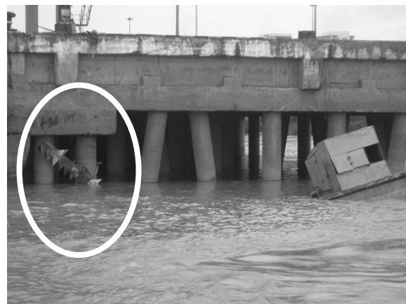
写真-1 国際貨物棧橋に設置された潮位表示塔 (○印)
