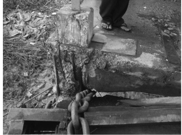
写真-4 栈橋本体に巻き付けられたチェーン
