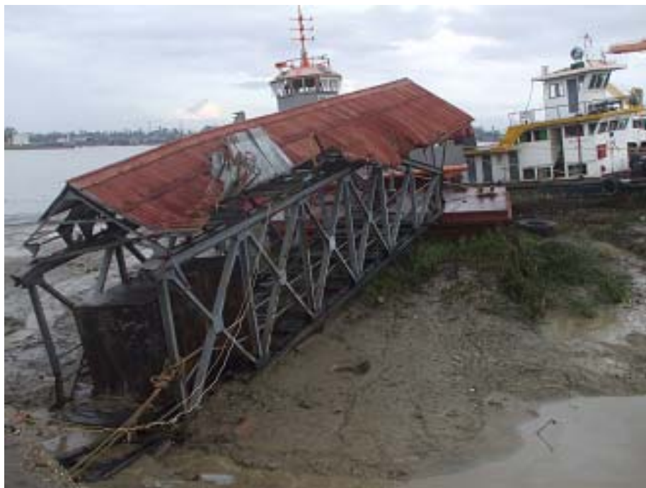
巻頭写真-4 ヤンゴン港作業基地の棧橋被害と作業船の乗り上げ
