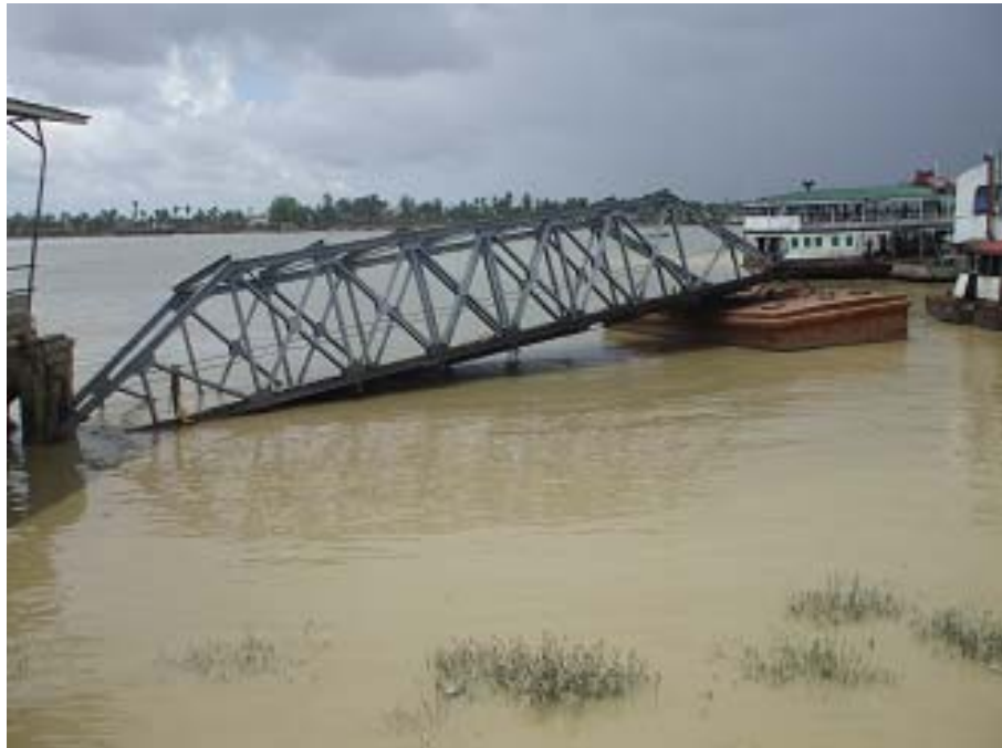
巻頭写真-1 ヤンゴン港における浮き棧橋（連絡橋）の被災
