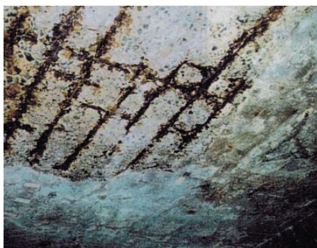
写真-1 栈橋上部工（スラブ）における塩害劣化事例（建設後約30年経過）
