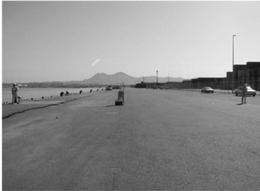
1 NO.3 被災状況
