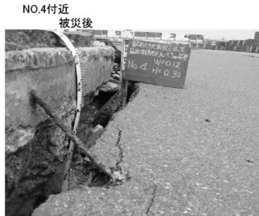
控え杭背後の変状
