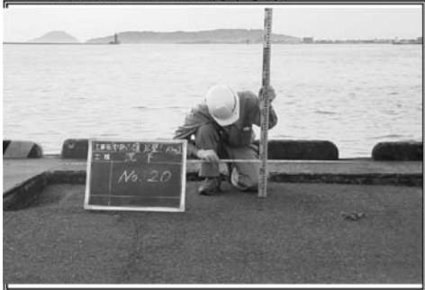
5 BNO.20 エプロン沈下状況
