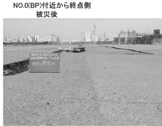
控え杭背後の変状
