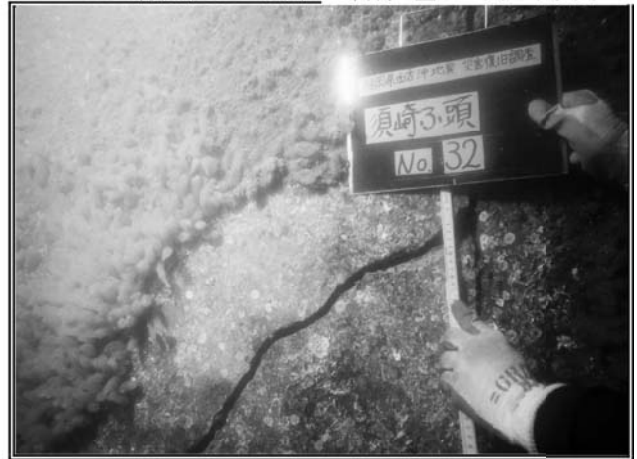
NO.4付近(32ブロック) 土留部L型ブロック クラック
