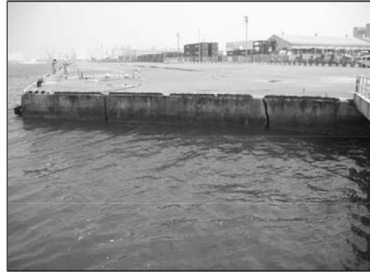
2ANO.2~ANO.2+13.9 被災状況(上部工正面)
