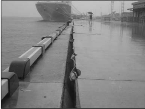
1被災状況(上部工全景)
