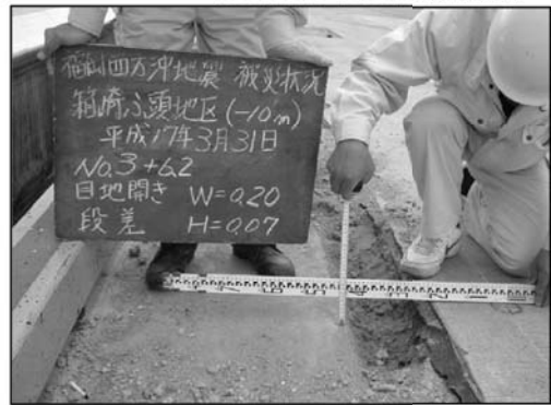
4NO.3+6.2 エプロン目地開き段差状況(目地開き最大)
