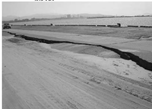
エプロン端部噴砂(控え杭背後)
