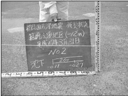
5 ANO.2 エプロン沈下状況
