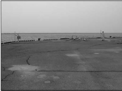
1ANO.2+13.9 被災状況
