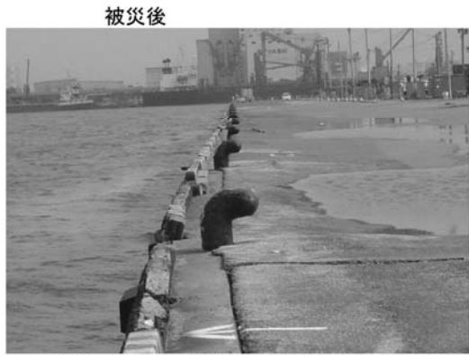
液状化に伴い前面鋼矢板のはらみ出し
