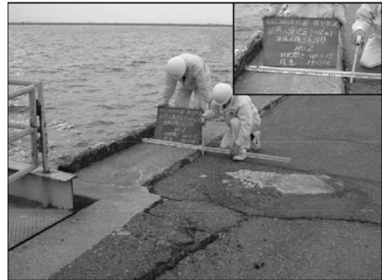
6ANO.2 目地開き・段差状況
