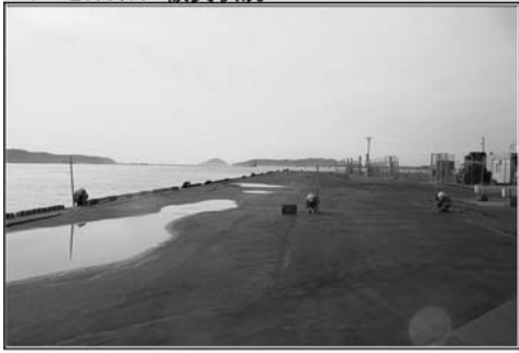
1 BNO.10 被災状況
