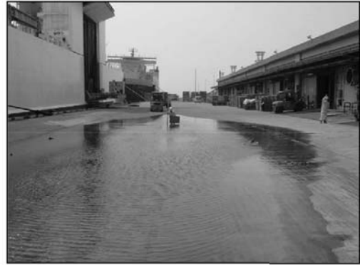
2被災状況(エプロン全景)
