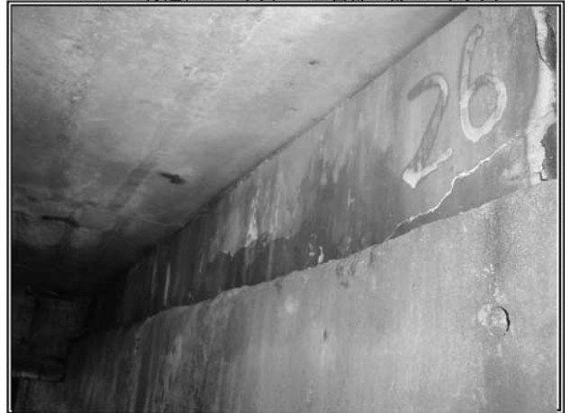
2 NO.8~9付近(26ブロック) 土留部上部工 クラック
