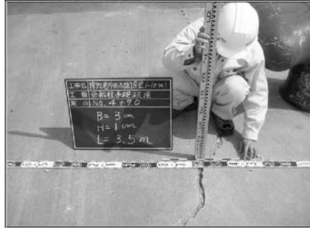
6 係船柱基礎破損
