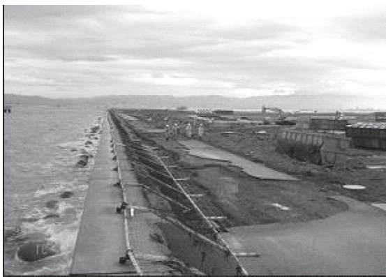
写真-1 被災状況
