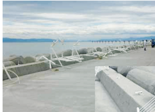
写真-1 フェンス被災の状況
