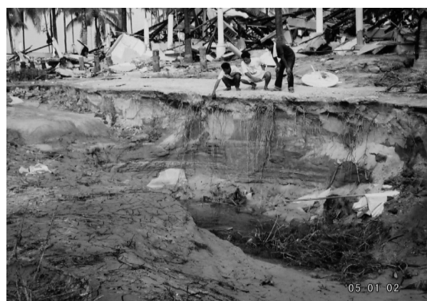
写真-2 海岸ホテル敷地の陥没
