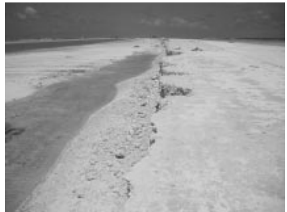
写真-4.7 両端が侵食された連絡道路（撮影：本多）
