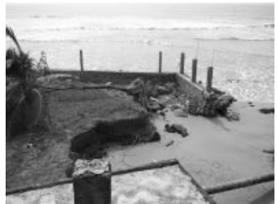
写真-3.5 侵食された護岸背後の地盤（撮影：富田）
