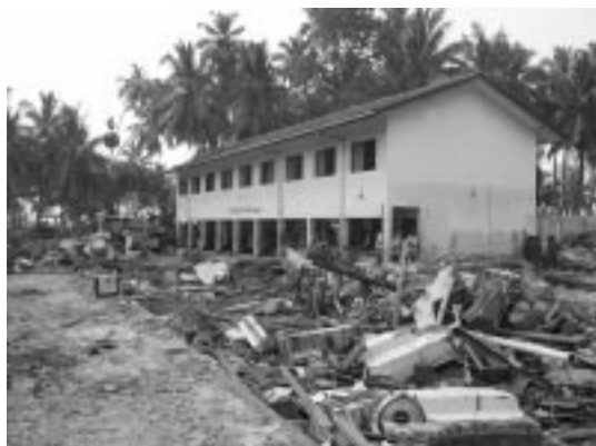
写真-3.9 建物に残る津波の水跡（撮影：今村）
