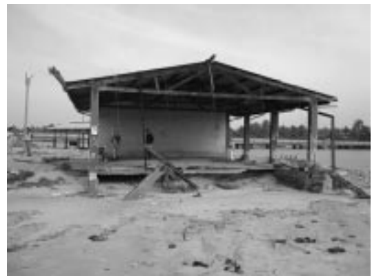
写真-3.4 床が破壊した建物（撮影：富田）
