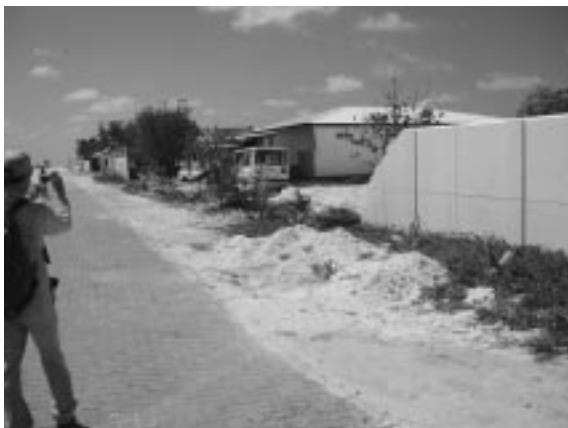
写真-4.8 破壊した内陸の壁（撮影：本多）
