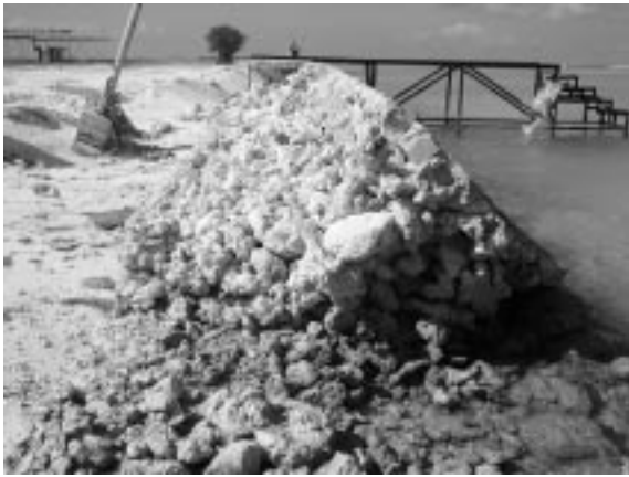
写真-4.10 崩壊した護岸（撮影：富田）
