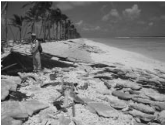
写真-4.6 被災したセメントブロックの護岸（撮影：本多）
