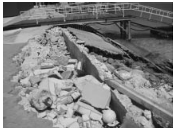
写真-4.9 破壊した護岸（撮影：本多）
