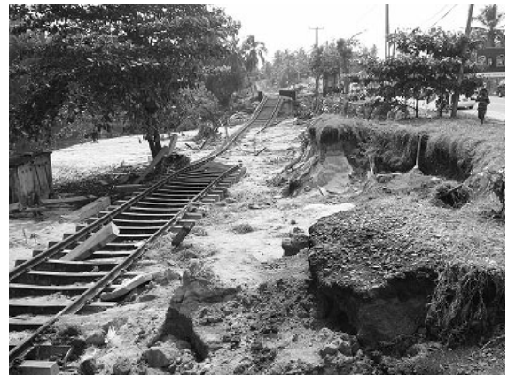
写真-3.8 線路の基礎地盤の洗掘（撮影：富田）
