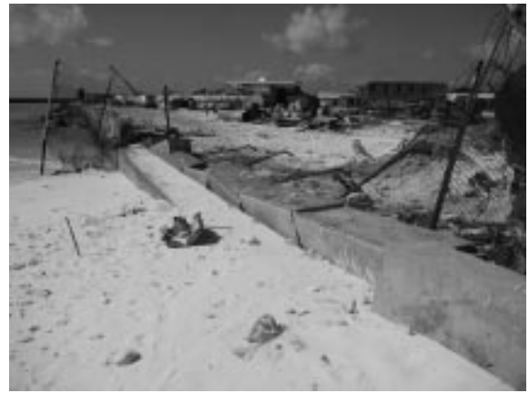
写真-4.11 倒壊した護岸上部工（撮影：本多）
