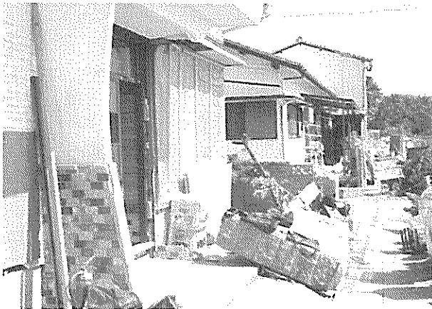
図-24 住宅地区における家屋の破壊状況(河合ら, 2000)
