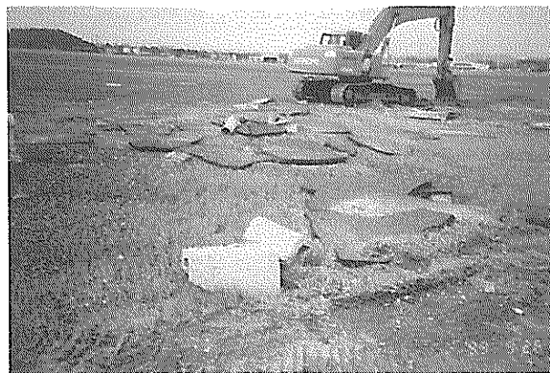
写真-2.20 山口宇部空港護岸 アスファルトの剥離流失
