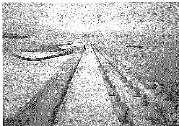
写真-2.21 山口宇部空港新設護岸 パラペット倒壊状況
