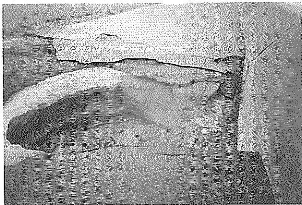
写真-2.19 山口宇部空港護岸 埋立土の吸い出し
