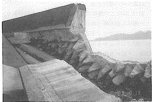
写真-2.30 山口港山口地区堤防 堤防コンクリート壁破断状況
