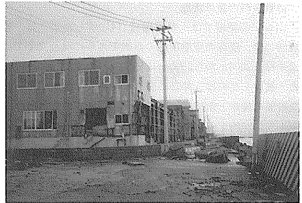
写真-2.15 新門司南護岸 護岸直背後の越波による被害
