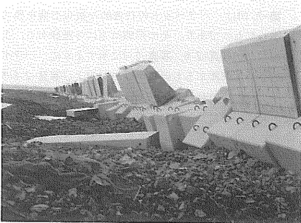
写真-2.5 新北九州空港新門司沖土砂処分場護岸 2工区被災状況
