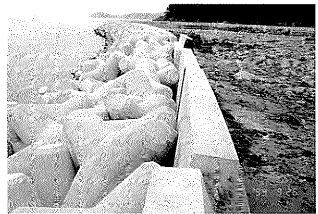
写真-2.33 三田尻中関港廃棄物埋立護岸 パラペット被災状況
