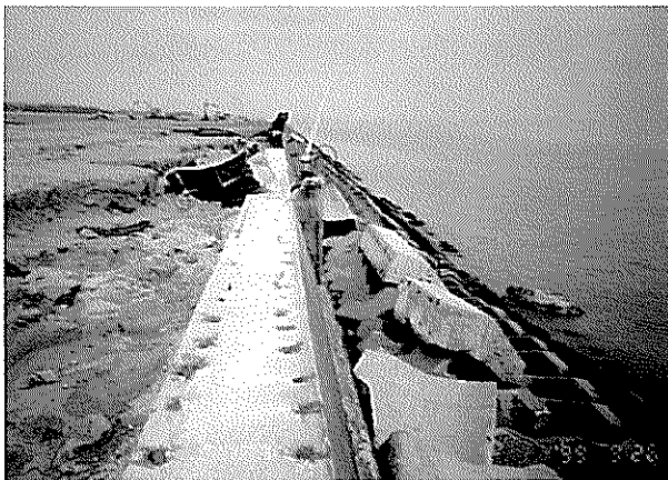
写真-2.18 山口宇部空港既設護岸 パラペット倒壊状況
