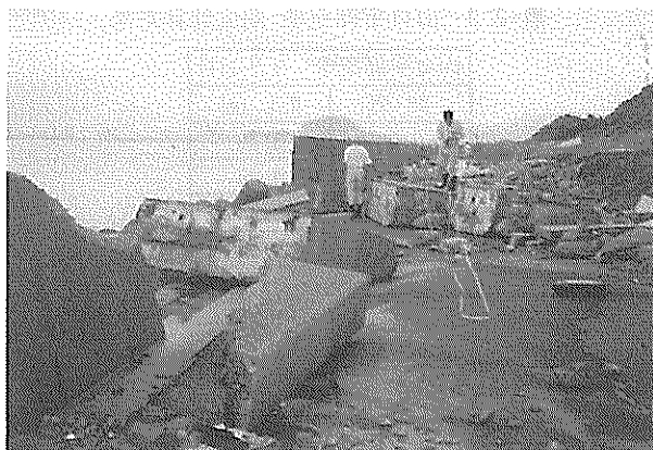
写真-2.14 新門司南地区 2号護岸 被災状況
