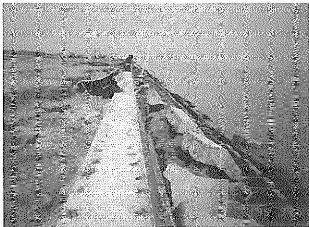
写真-2.18 山口宇部空港既設護岸 パラペット倒壊状況
