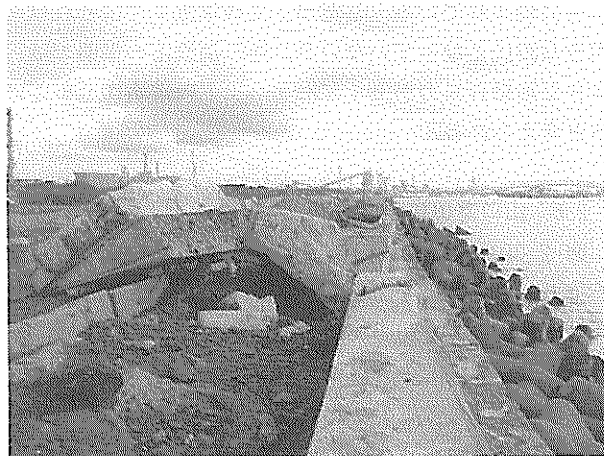
写真-2.25 小野田地区西沖護岸 パラペット倒壊状況
