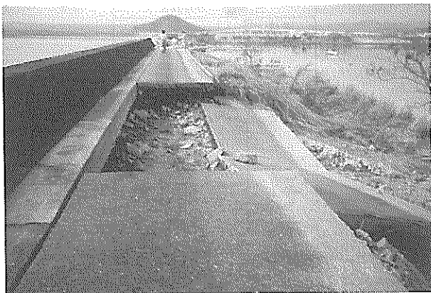
写真-2.29 山口港山口地区堤防 水たたきコンクリート沈下状況
