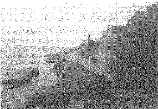
写真-2.11 新北九州空港荊田沖土砂処分場東護岸 南側根固めブロック移動状況
