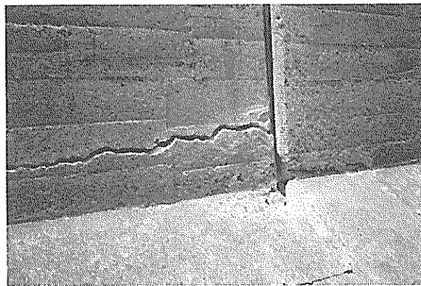
写真-2.26 小野田地区西沖護岸 パラペット背後の亀裂
