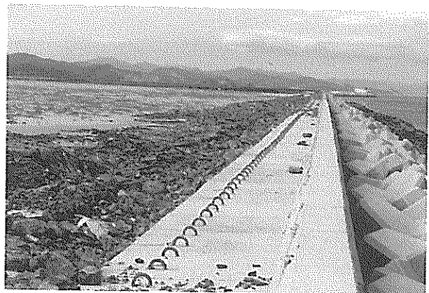
写真-2.4 新北九州空港新門司沖土砂処分場護岸 1工区被災状況
