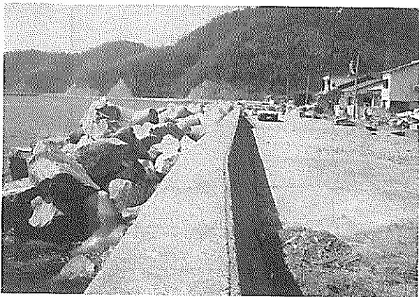
写真-5.1 住宅地前方の護岸(住民の話では、パラペットが見えなくなるほど海面が高くなった。)
