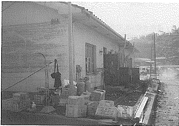
写真-5.10 浸水した家屋(和田船溜と仲西船溜の中間付近の住宅で、壁に痕跡がある。)
