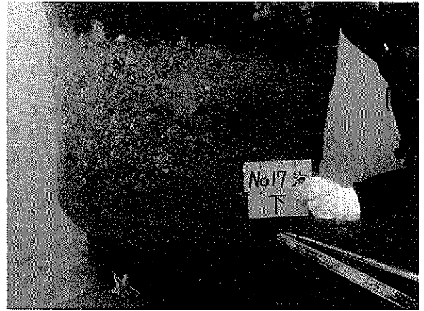
写真-6 海底面付近の鋼管杭の腐食状況 (杭No.17)
