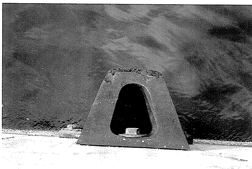
図-3 防舷材の破損状況 (欠損の例)
