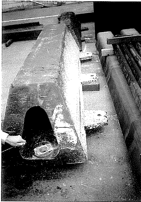
写真-4 防舷材損傷状況 (V型600H×2,500L)
