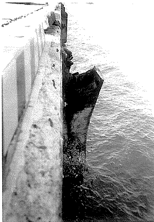
図-6 防舷材の破損状況（永久変形の例）
