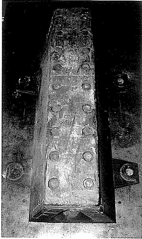
写真-3 防舷材損傷状況 (V型600H×1,900L)
