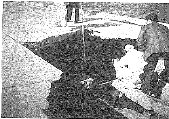
写真-1 鋼矢板構造物の集中腐食による被害例
