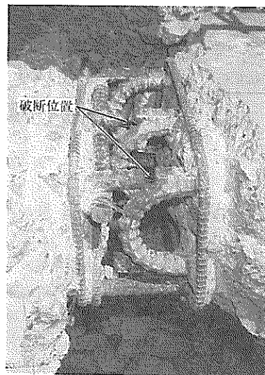
写真一18 疲労試験体の鉄筋破断状況 (TYPE-A)
