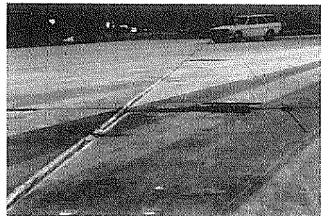
写真-2 段差の状況
