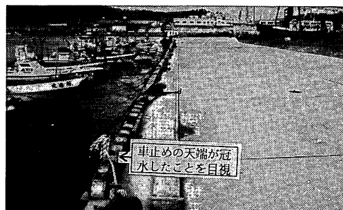
写真-5.6 久慈港諏訪下地区の冠水護岸の状況
