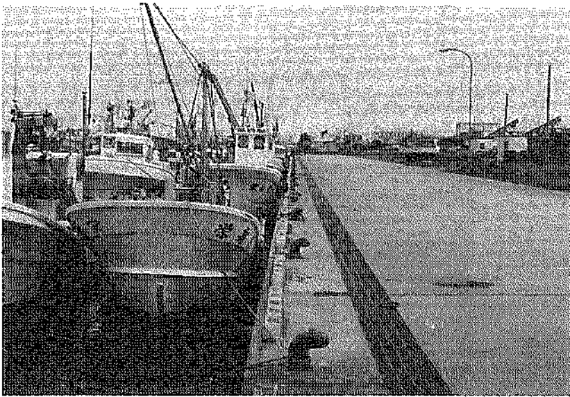
写真-3.3.27 地震後の状況 (㊹西-2.5m 物揚場：無被災、平成5年11月撮影)
