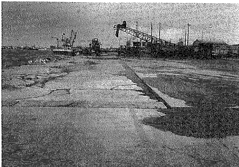
写真-3.3.30 エプロンの被災状況 (㊸岸壁 (-5.5m)、重力式区間)
