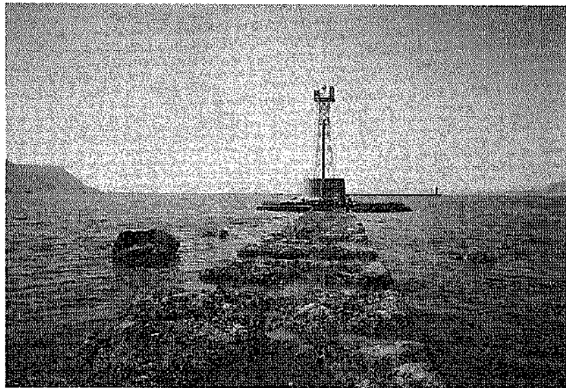
写真—3.2.56 沈下 (函館港、七重浜地区防砂堤、本体)
