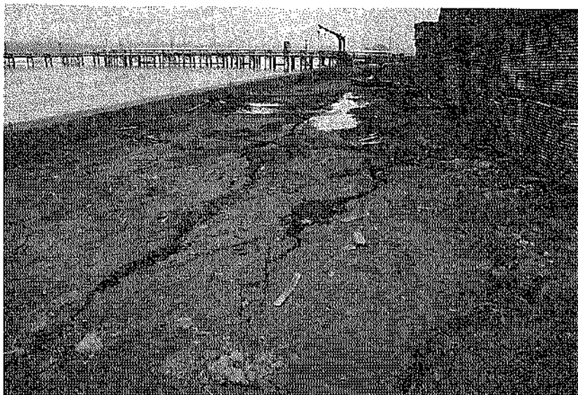
写真—3.2.55 龟裂 (函館港、七重浜地区護岸、埋立地)
