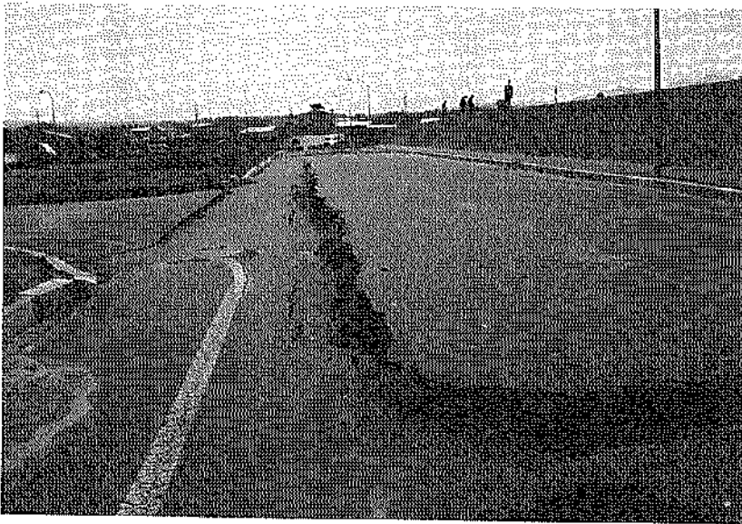
写真—3.3.17 護岸控え工位置での道路上の亀裂・段差および道路の開き・沈下状況 (①西防波護岸・②西臨港道路、平成5年11月撮影)
