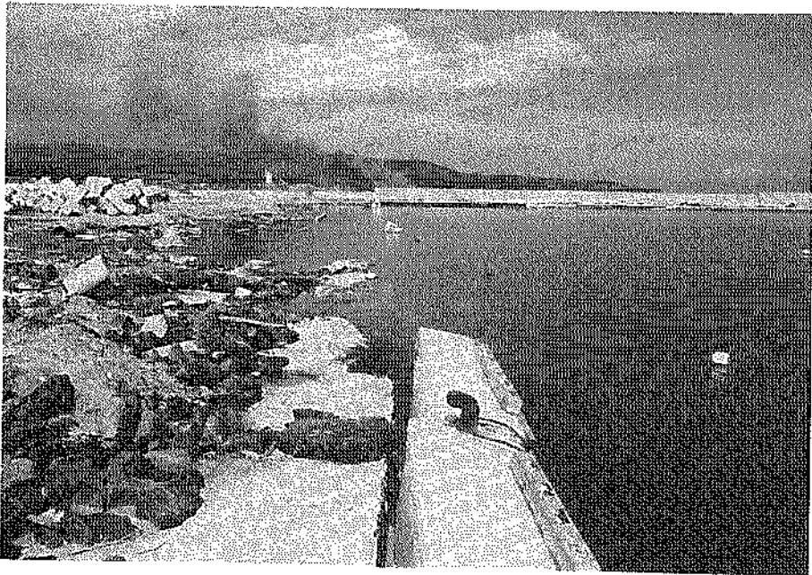
写真—4.1.22 岸壁倒壊状況 (青苗漁港、㊸—3.5m 岸壁)
