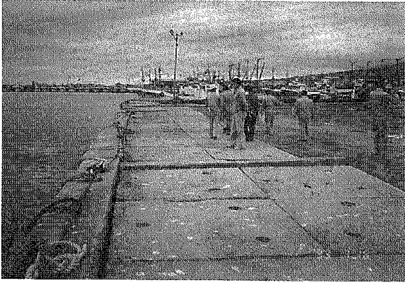
写真—3.3.50 法線変位およびエプロン被災状況 (㊤中央埠頭先端取付部、重力式区間)
