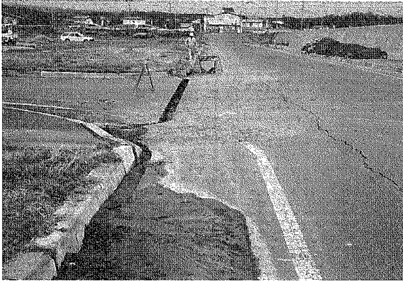
写真—3.3.16 護岸控え工位置での道路上の亀裂および道路の開き・噴砂状況 (①西防波護岸・臨港道路)
