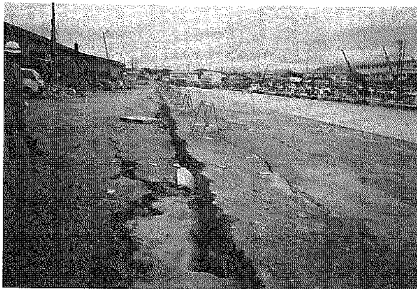
写真-3.3.59 控え工位置での亀裂・段差状況 (㊦第1 洞内物揚場 (-4.0m))
