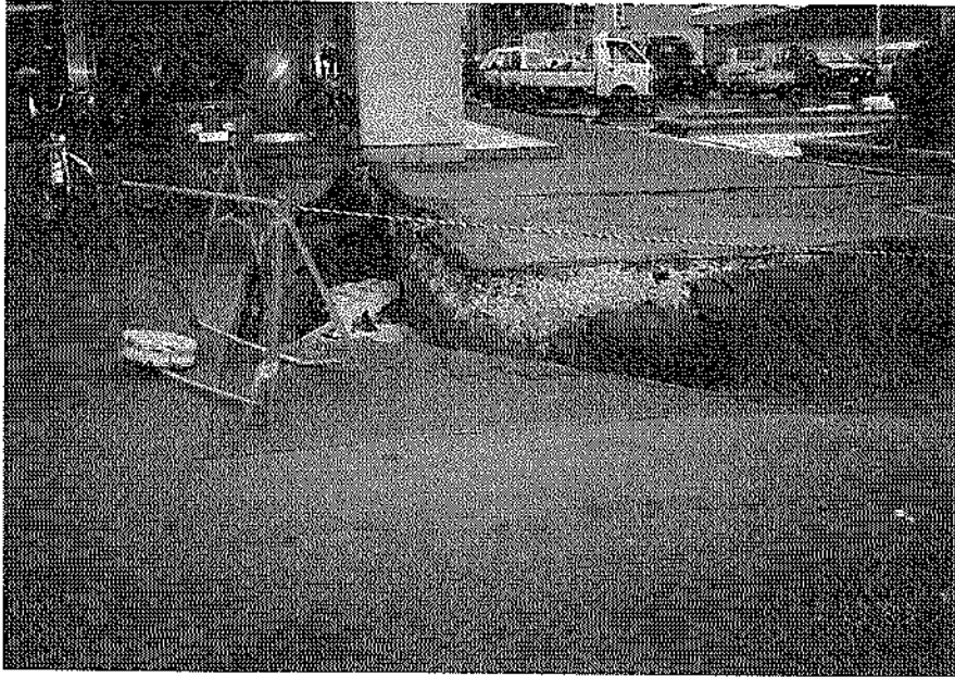
写真-3.2.13 段差 (函館港、豊川埠頭岸壁 (旧鋼管杭)、エプロン)
