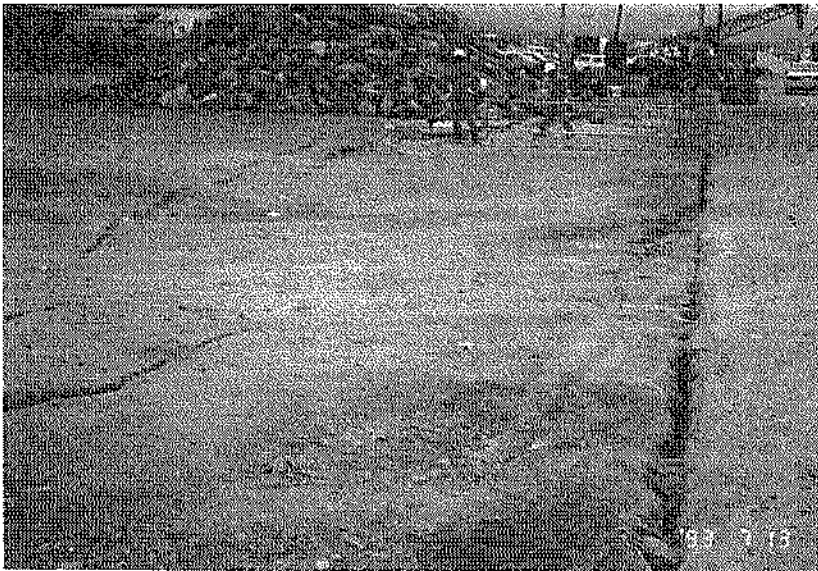
写真-3.3.33 エプロン背後地盤の亀裂・沈下状況 (㊸岸壁 (-5.5m)、矢板式区間)
