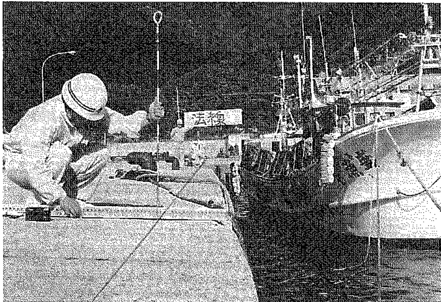
写真—4.2.4 法線の変位状況（須築漁港、①—4.0m岸壁、SP140.0~170.6）
