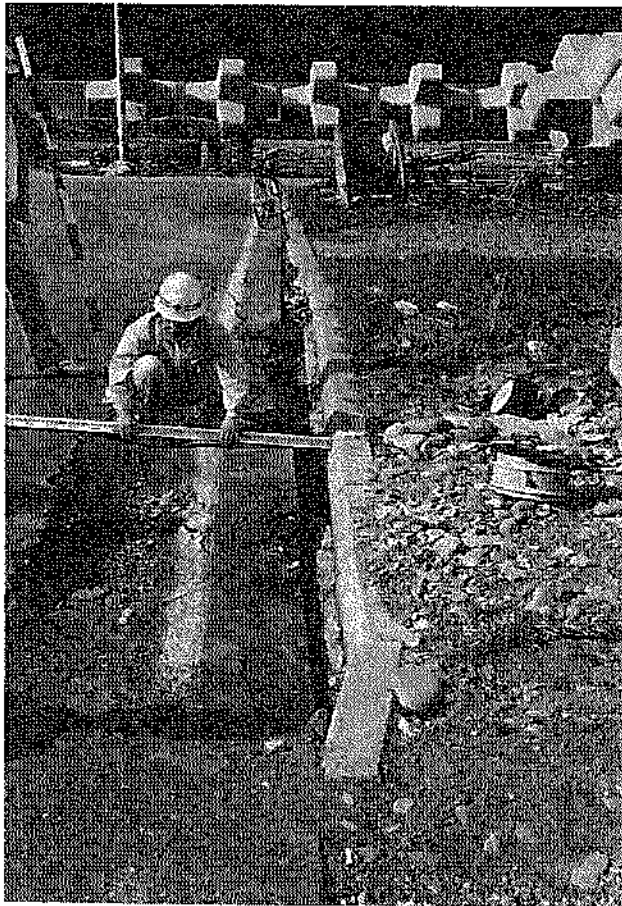
写真—4.2.12 —4.0m 岸壁背後の道路の被災状況（須築漁港、㊸道路）
