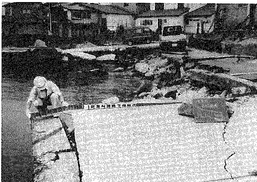
写真-3.1.7 奥尻港雨物揚場の被災状況
