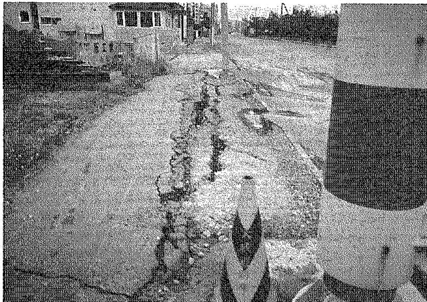
写真-3.2.43 亀裂（函館港、北埠頭、臨港道路）
