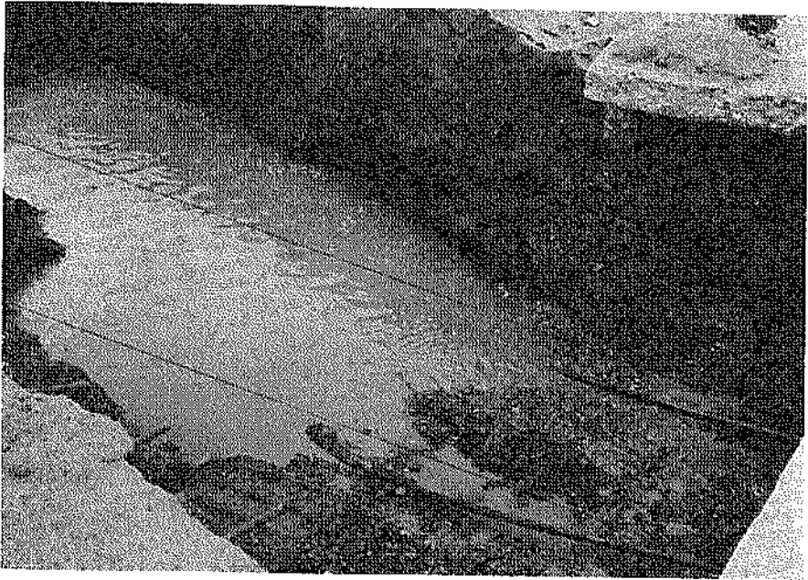
写真—3.2.25 タイプル緩み (函館港、若松地区道路護岸)
