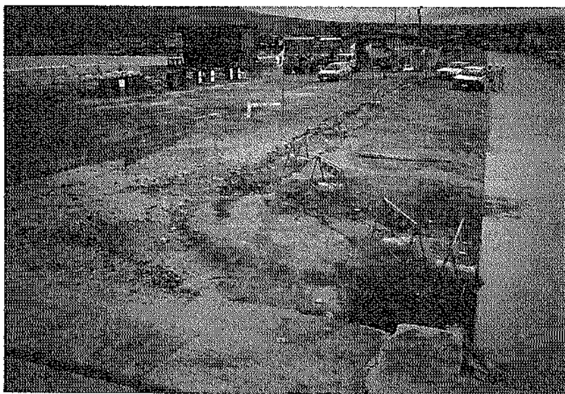
写真—3.3.62 控え工位置での被災状況 (㊦第1洞内物揚場 (-4.0m))
