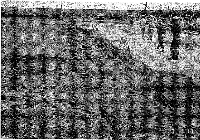
写真-3.3.23 控え工位置での亀裂・噴砂状況 (③西-2.5物揚場)
