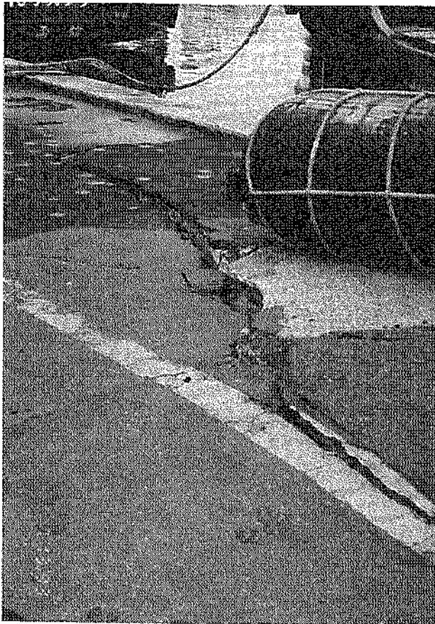
写真-3.2.11 亀裂 (函館港、末広地区物揚場、エプロン)
