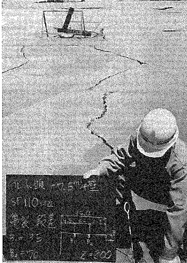
写真-3.2.40 亀裂 (函館港、北埠頭、北側岸壁、エプロン)
