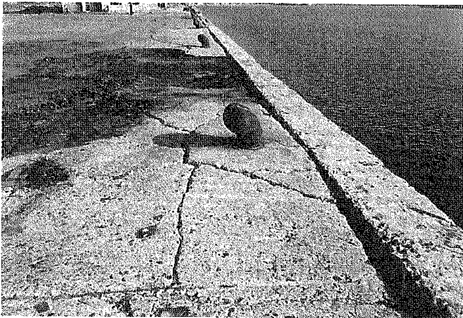
写真-4.1.15 エプロンの沈下および上部工との段差（青苗漁港、⑨-4.0m岸壁）
