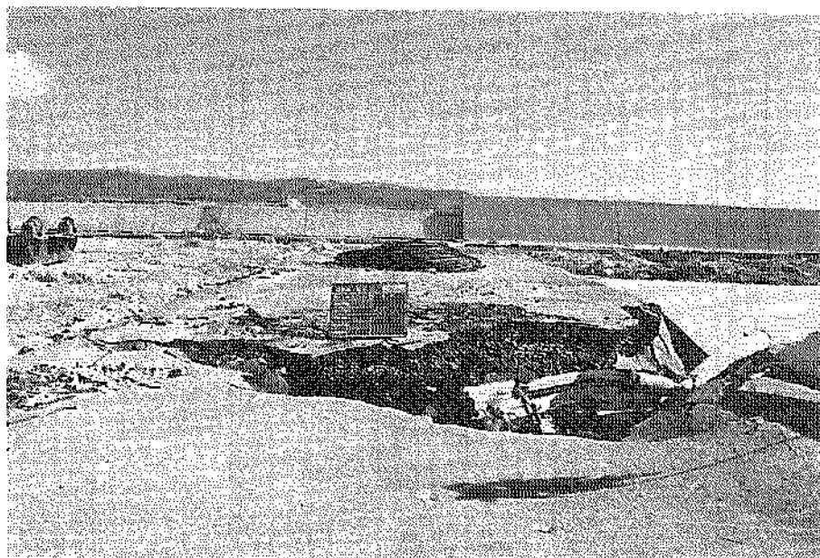
写真—4.1.26 船揚場（北）西側の道路被災状況（青苗漁港、⑨道路）
