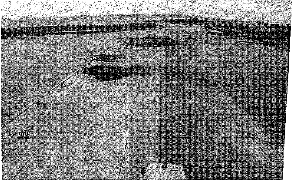
写真-4.1.14 エプロンの沈下・亀裂（青苗漁港、⑨-4.0m岸壁）
