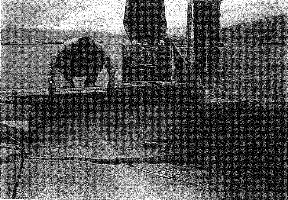
写真-4.4.5 エプロン部の沈下・亀裂・段差状況（上磯漁港、②南護岸）
