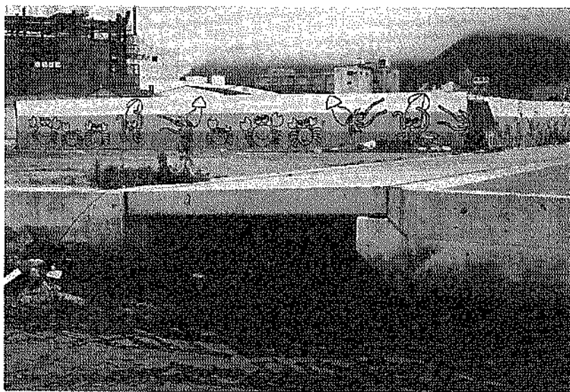
写真—3.2.16 波版ブロック沈下（函館港、豊川埠頭岸壁（旧鋼管杭））
