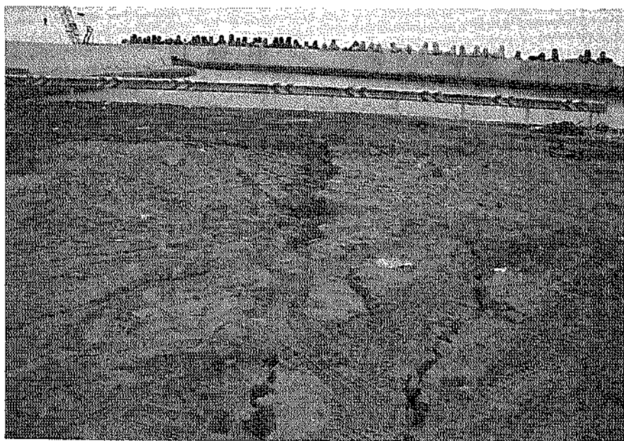
写真—4.3.9 背後地盤の沈下・亀裂・段差・噴砂状況 (長万部漁港、④—3.0岸壁)
