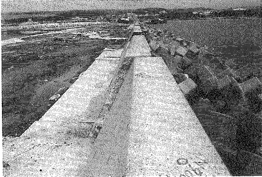
写真—4.1.28 上部工段差・亀裂・ズレ状況（青苗漁港、⑭東護岸）
