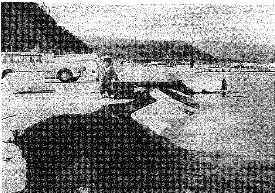
写真-3.1.9 奥尻港埠頭南物揚場の取付先端部の被災状況
