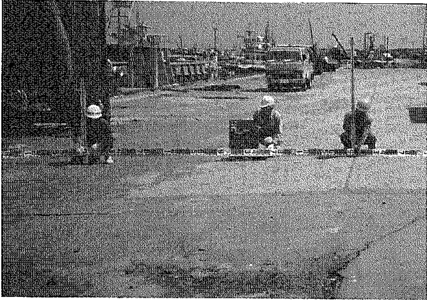
写真—3.3.34 エプロン沈下状況 (㊟岸壁 (-5.5m)、矢板式区間)
