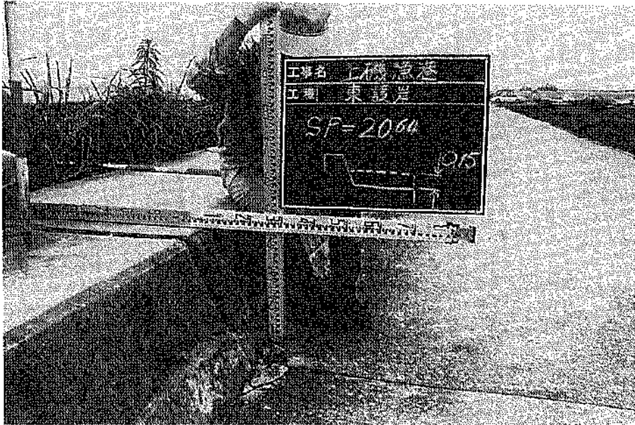
写真-4.4.9 エブロン部の沈下状況 (上磯漁港、③東護岸)
