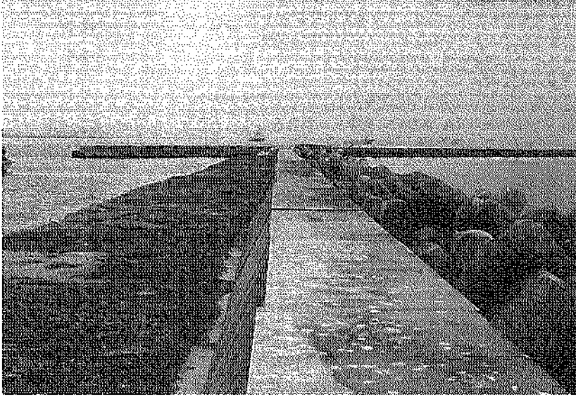
写真—3.2.63 法線変位 (函館港、本港地区、北副防波堤、ケーソン)
