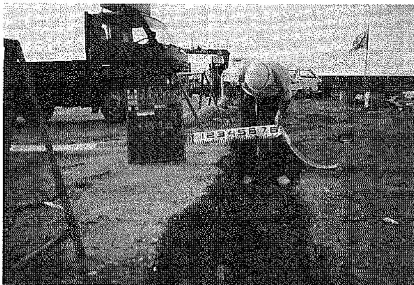
写真—3.3.61 控え工位置での亀裂・開き・段差状況 (㊦第1洞内物揚場 (-4.0m))
