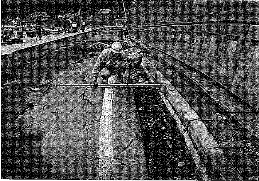
写真—4.2.11 —4.5m 岸壁背後の道路の被災状況（須築漁港、㊸道路）
