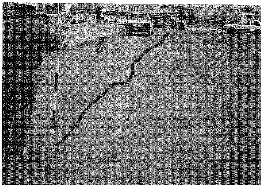
写真—4.3.5 アスファルト舗装の亀裂（長万部漁港、③道路 その2）
