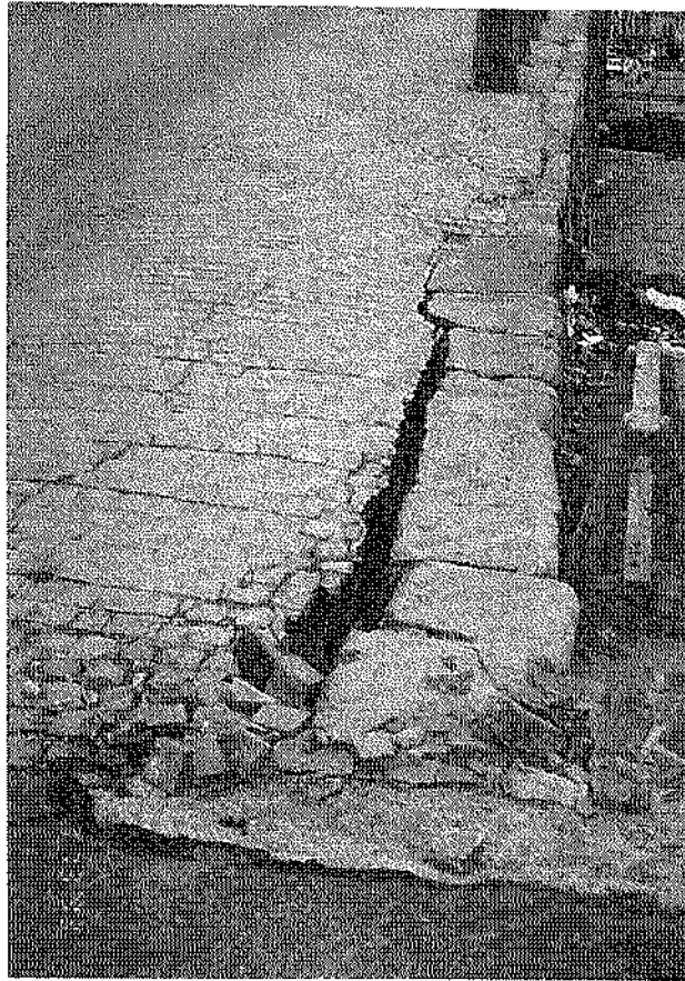
写真-3.2.12 不等沈下 (函館港、末広地区物揚場、エプロン)
