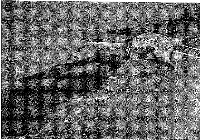
写真-3.3.26 控え工位置での亀裂および排水工の被災状況 (㊸西-2.5m 物揚場)
