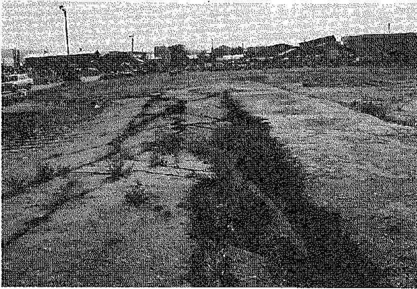
写真—3.3.53 背後地盤の亀裂・段差・沈下状況 (㊸中央埠頭先端取付部、平成5年11月撮影)
