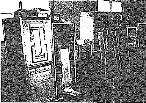
(3) 監視局視測機器
