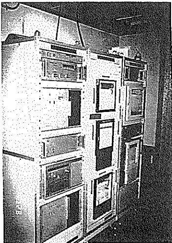
(5)監視局観測機器(工事課)
