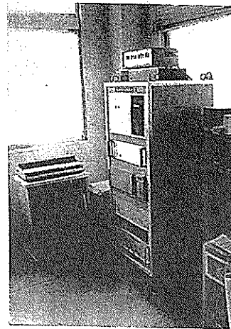
(5) 監視局施設機器
