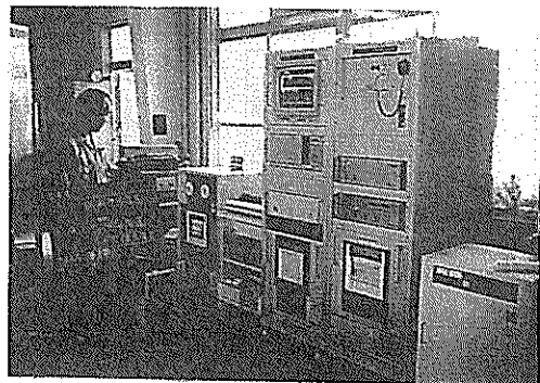
(6)監視局観測機器
