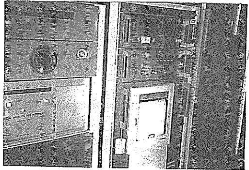
(4) 監視局内観測機器
