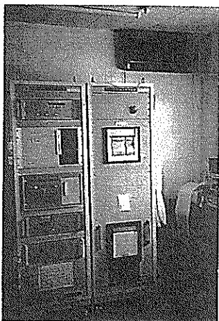
(3)監視局観測機器
