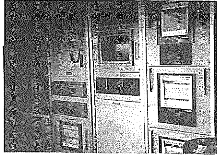
(2) 監視局施設機器
