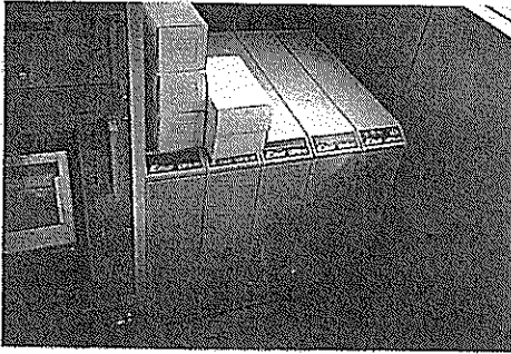
(3)監視局観測機器(非常電源装置)
