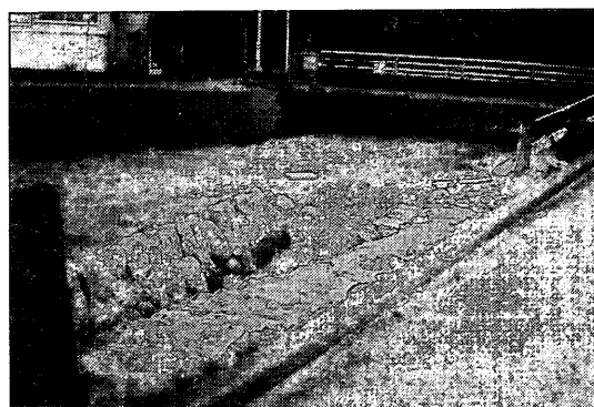
写真-6.17 (24) 奥尻港南部の状況 津波流出経路にあたる胸壁の転倒
