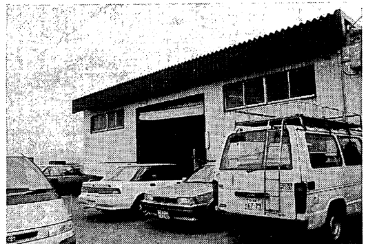
写真-6.2 江差港フェリー発着場倉庫 津波によってシャッターが損傷を受けた
