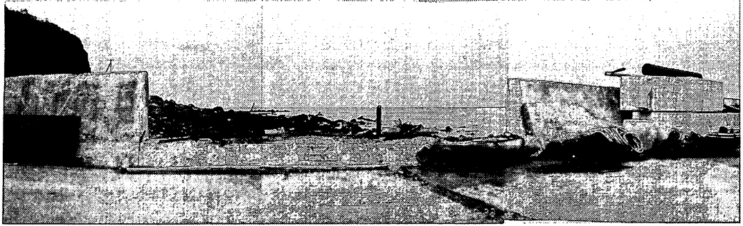
写真-6.20 (1) 稲穂漁港 津波により胸壁が転倒した部分
