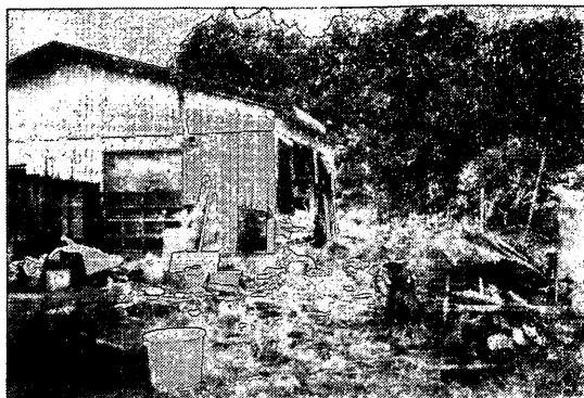
写真-6.17 (9) 奥尻港北部の被災状況 大きな被害を受けた家屋
