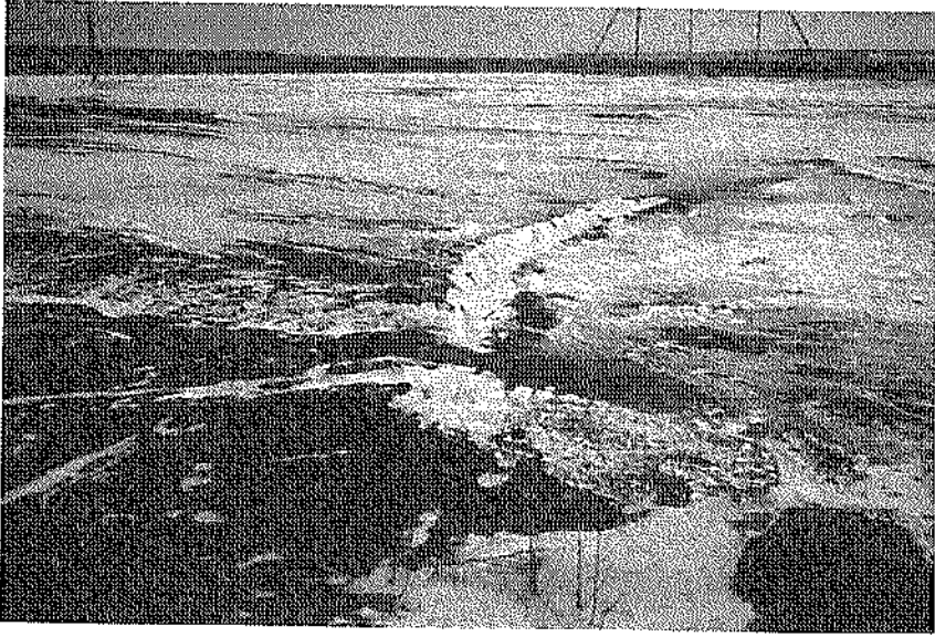
写真-4.4.1 岸壁後方地盤の噴砂跡 (根室港花咲地区, ①東岸壁(-10.0m))
