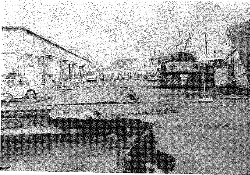
写真—3.2.32 被災状況漁業埠頭, ①東側岸壁 (-7.0m)
