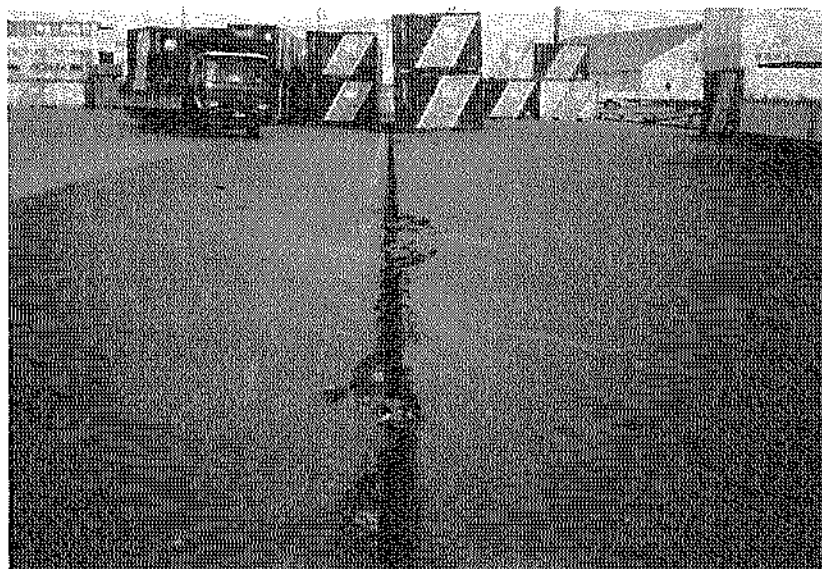
写真-3.3.30 エプロン被災状況 (第2埠頭地区, ①東側岸壁(-5.5m))
