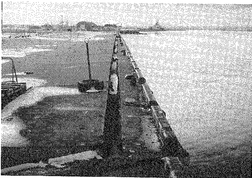
写真-4.3.4 法線変位状況 (霧多布港：㊦東-4.0m物揚場)
