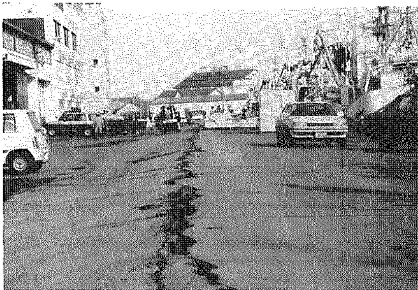
写真—3.2.33 被災状況漁業埠頭①東側岸壁 (-7.0m)
