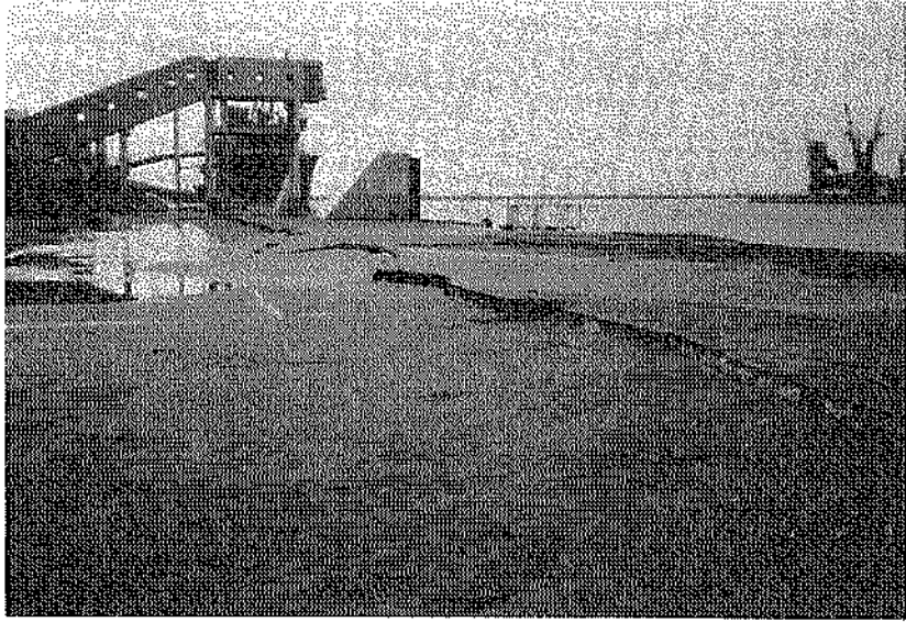
写真—3.3.25 エプロン沈下、亀裂状況（第1埠頭地区，㊸西側岸壁(-9.0m)）
