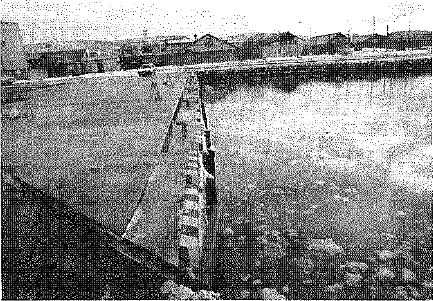
写真-4.3.6 法線変位状況（霧多布港：㊦物揚場(-2.0m)）
