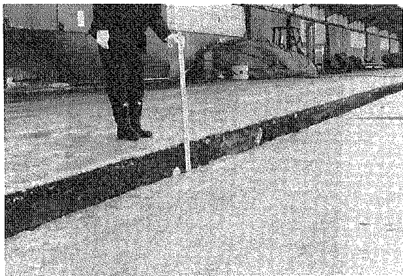
写真—3.2.50 被災状況副港地区⑤岸壁 (-5.0m)
