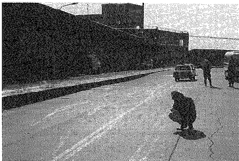
写真—3.2.49 被災状況副港地区⑤岸壁 (-5.0m)
