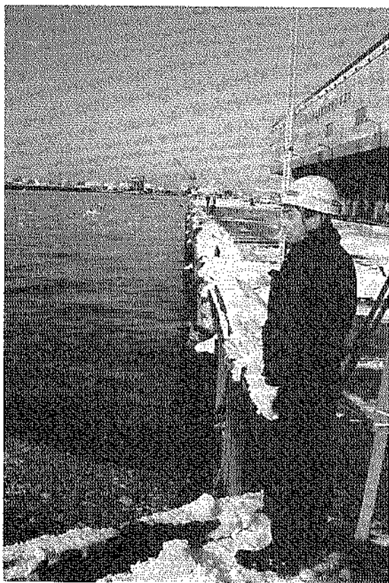
写真-3.2.47 被災状況副港地区①岸壁 (-6.0m)
