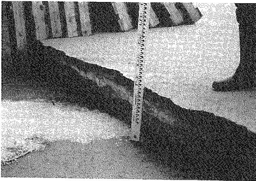
写真—3.2.24 被災状況北埠頭④西岸壁 (-9.0m)
