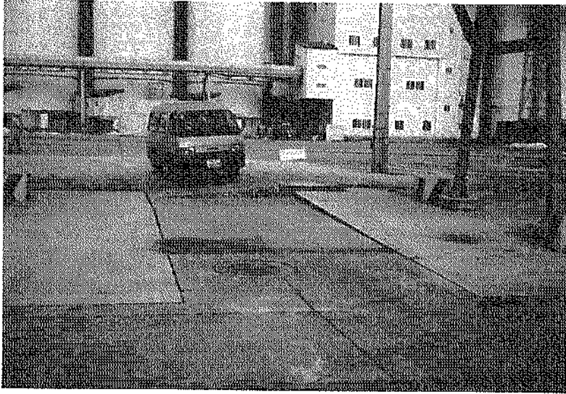
写真-3.3.35 エプロン背後の被災状況 (第2埠頭地区, ④・⑤南側岸壁(-12.0m))
