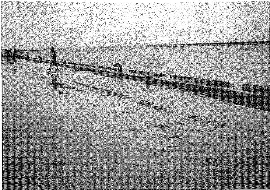
写真-4.3.3 エプロン沈下状況（霧多布港：㊹岸壁(-5.0m)）
