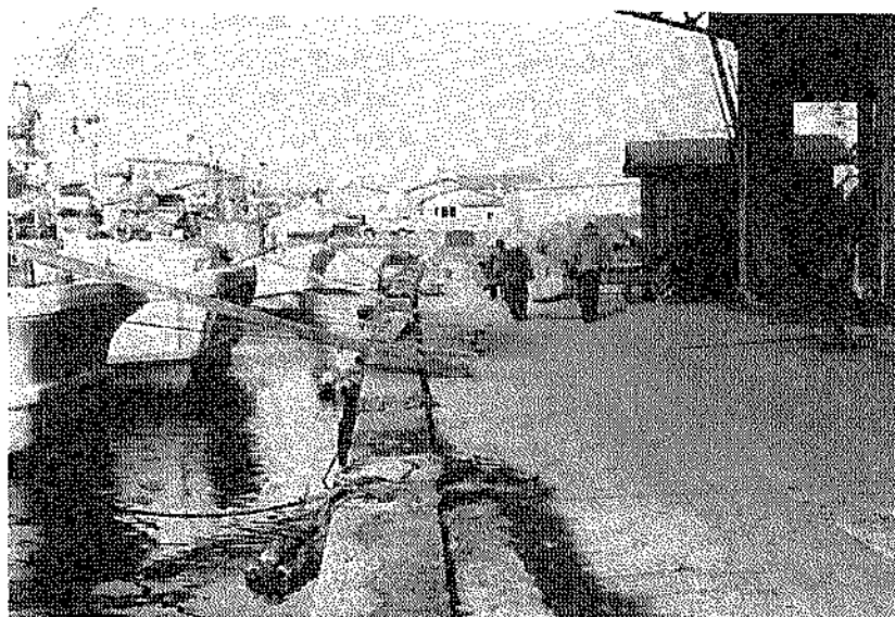
写真—3.2.53 被災状況副港地区④物揚場（—4.0m）
