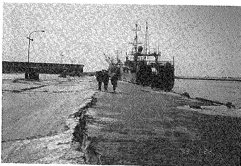
写真—3.2.44 被災状況漁業埠頭③西側岸壁 (-7.0m)
