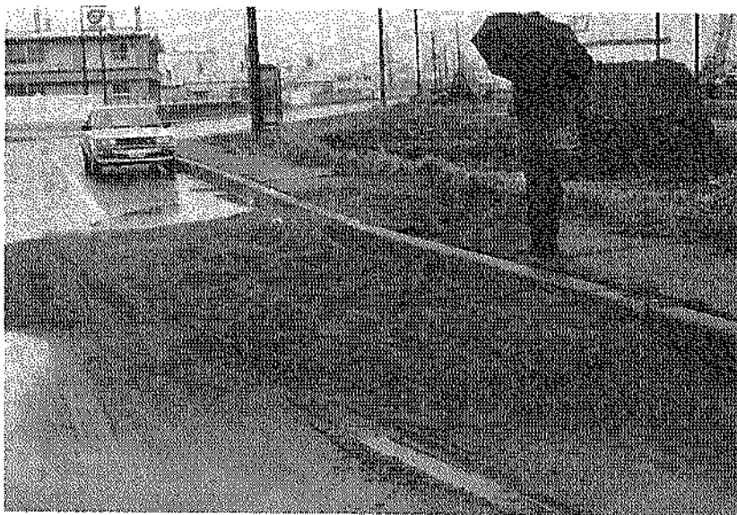
写真-3.3.29 道路・歩道での噴砂跡 (第1埠頭地区, 1993年4月撮影)
