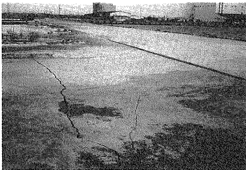
写真—3.3.42 エプロン背後の沈下状況（第3埠頭地区，②東側岸壁（-5.5m））
