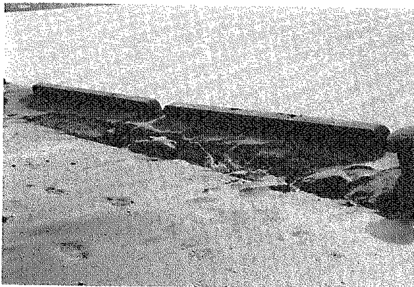
写真—3.2.43 被災状況漁業埠頭②南側岸壁の噴砂現象
