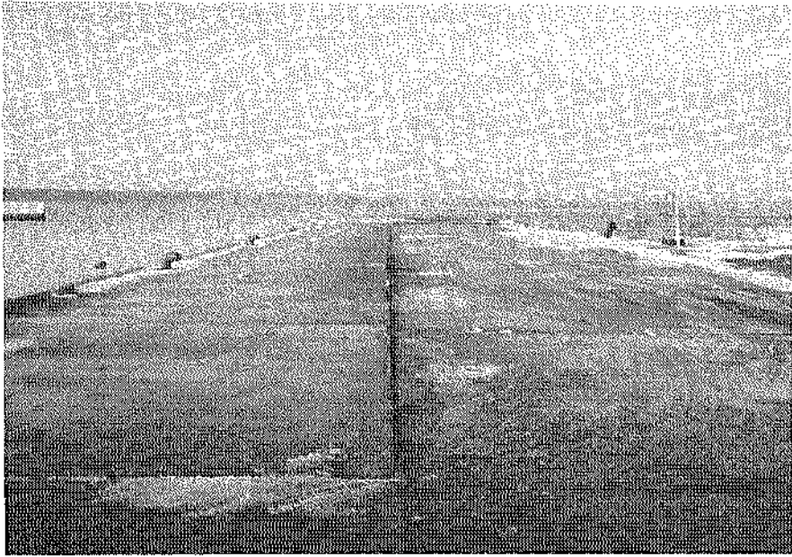
写真-4.3.2 エプロン沈下状況（霧多布港：㊸-5.0m岸壁）
