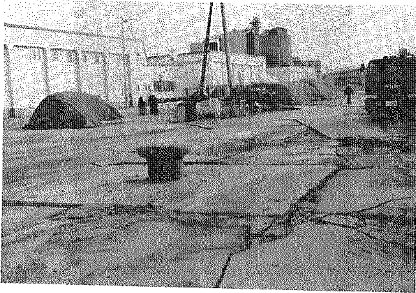
写真—3.2.28 被災状況北埠頭⑤岸壁 (-9.0m)
