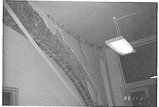
写真-49 フェリービルディングの内壁の剝離
