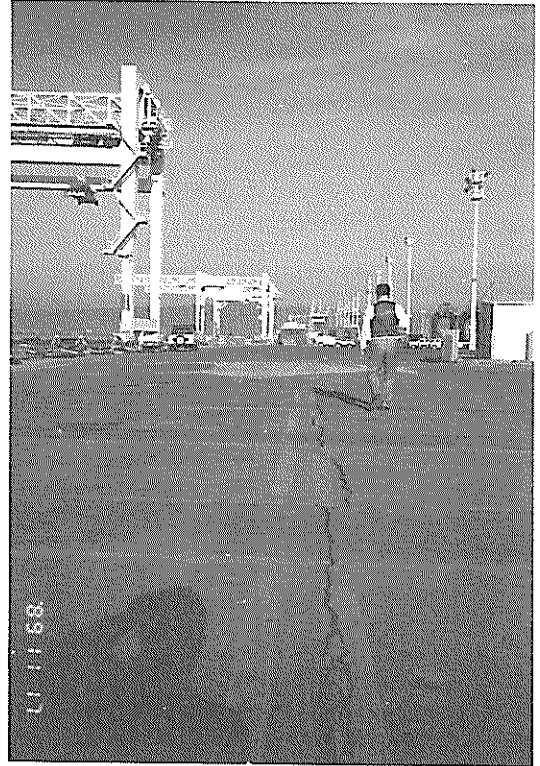
写真-8 7th Street ターミナルの埋立て地盤のクラック(バース37)
