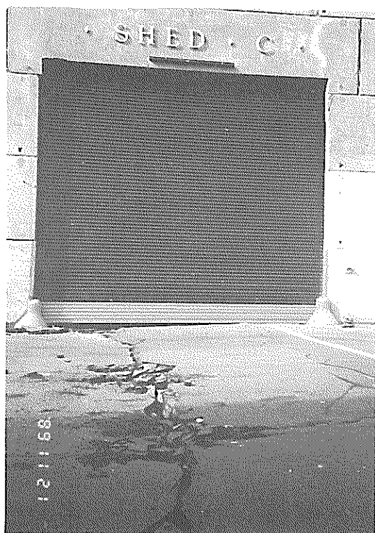
写真-35 第45埠頭の上屋の入口前のクラック
