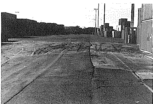
写真-22 ハワードターミナルの旧岸壁法線付近の液状化 (オークランド港湾局提供)
