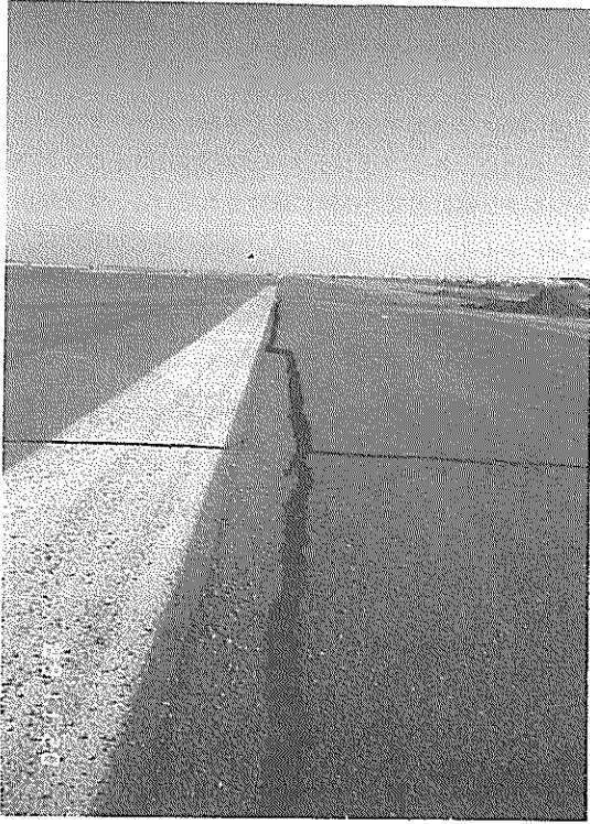
写真-63 オークランド空港の滑走路のクラック
