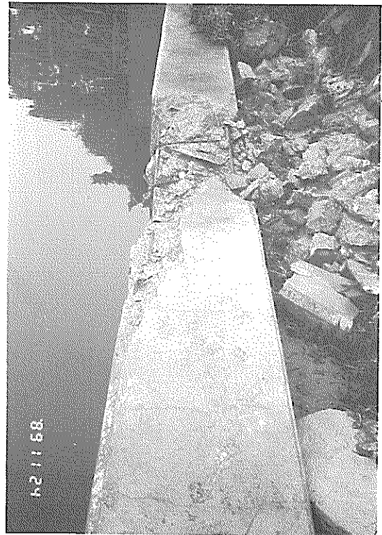
写真-54 サンタクルズ港の矢板式護岸の上部工のクラック
