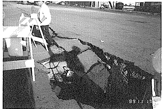
写真-15 7th Street ターミナルの陥没 (バース40)
