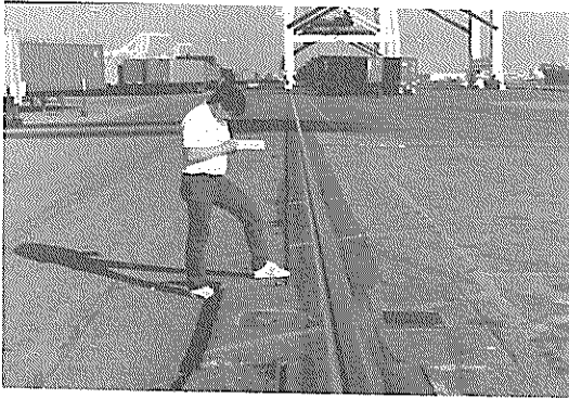
写真-16 APL ターミナルの棧橋の背後地盤の沈下 (オークランド港湾局提供)
