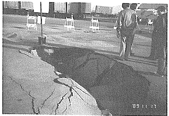
写真-17 APL ターミナルの液状化
