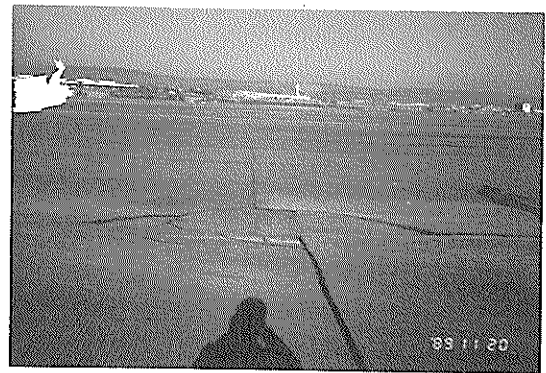
写真-65 オークランド空港の滑走路の目地開き
