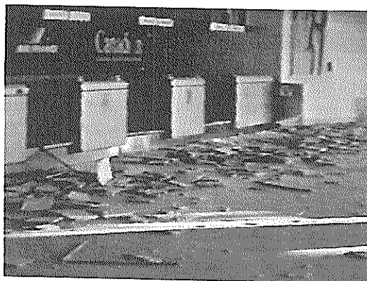
写真-74 サンフランシスコ空港の航空会社カウ ンター前に落下した天井板(空港事務所提供)
