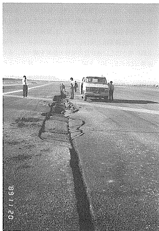
写真-62 オークランド空港の滑走路の目地開きと陥没
