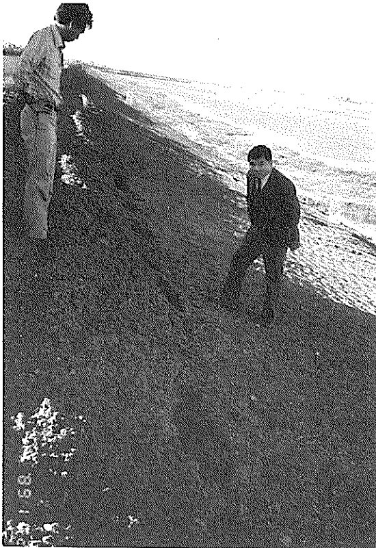
写真-66 オークランド空港の堤防のクラック
