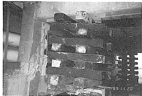
写真-68 オークランド空港の通路のせん断破壊した支柱
