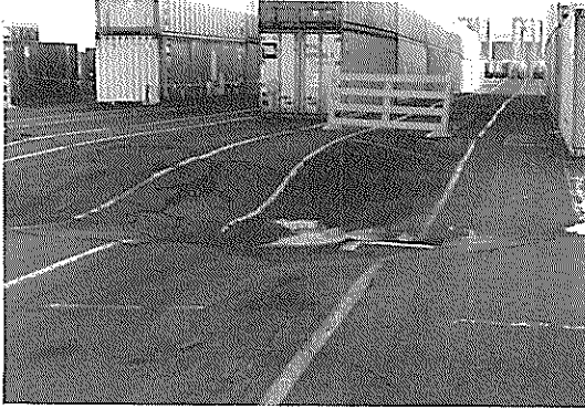
写真-23 マトソン ターミナルの陥没-1 (オークランド港湾局提供)
