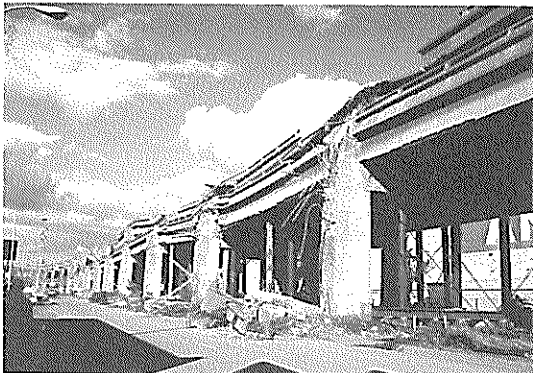
写真-3 オークランド市内サイプレス高架橋の被害状況
