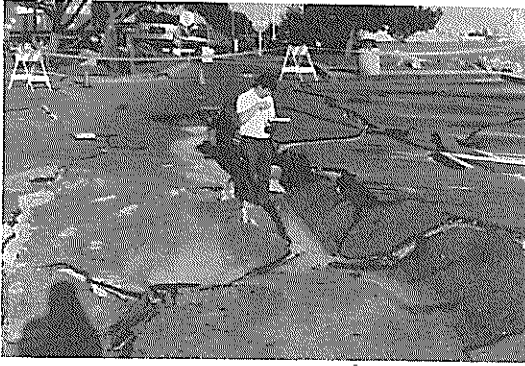
写真-32 7th Street ターミナルの公園の陥没、クラック (オークランド港湾局提供)
