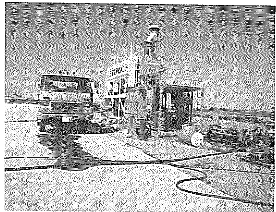
写真-8 グラウトプラント
