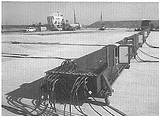
写真-7 油圧ホース集中ラック
