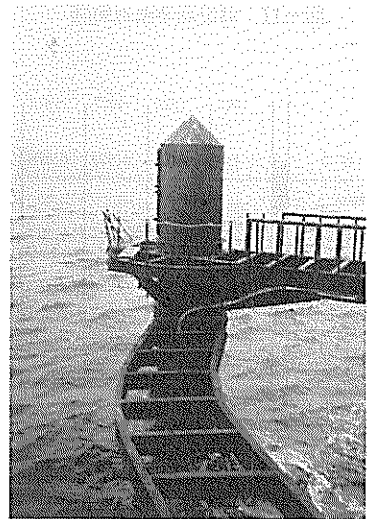
写真-6 波によって歪曲した検潮施設
