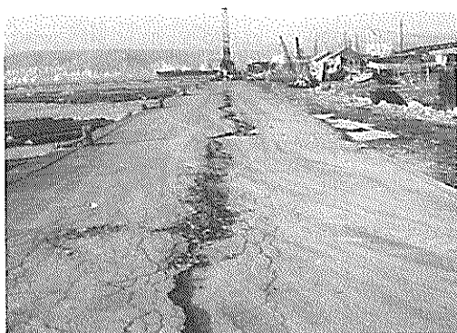
写真-6 西一号ふ頭西側岸壁 (エプロンのき裂)
