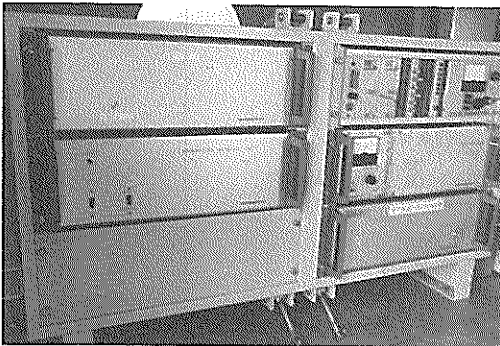
写真-5.10 観測局テレメータ装置(小松島港)
