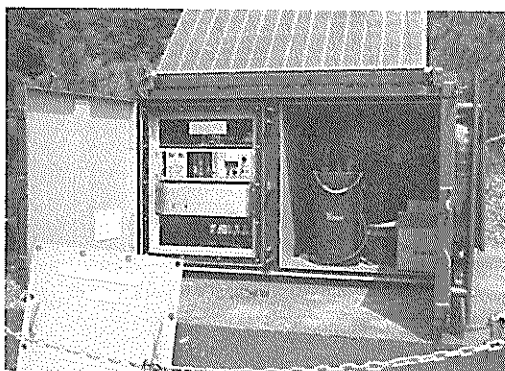
写真 - 5.13 中継局施設(浜田港)
