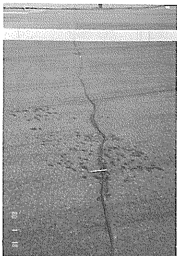
写真-2.1 アスファルト舗装における配線溝の蛇行
