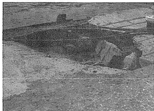
⑥ 上部工の陥没状況
