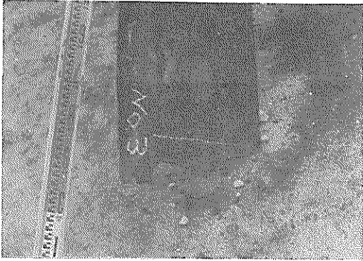
③ 鋼矢板No.3の破断状況
