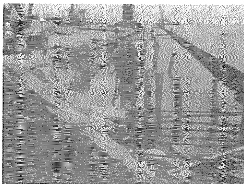
図3・26 バイブロ・ハンマによる鋼矢板の引き抜き(富山港、-3.0m物揚場)
