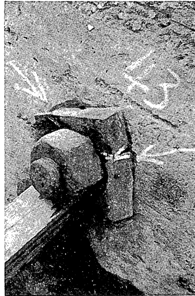
写真 5.1 大湊港下北ふ頭2号岸壁(-6.5m)控え版被災状況
